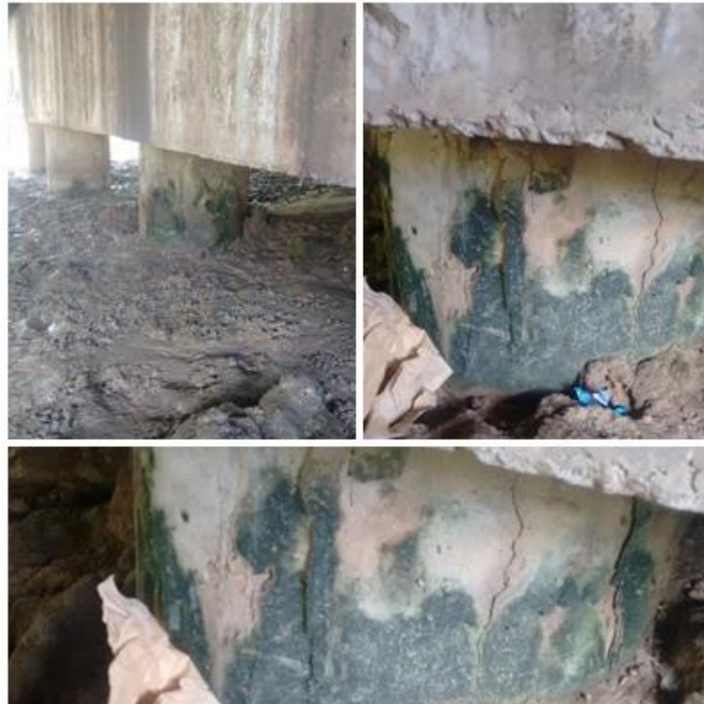
Figura 20. Trincas se propagando em alguns pilares
