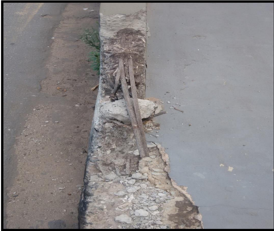
Figura 17. Cabeceira da ponte danificada(Perda de Material)
