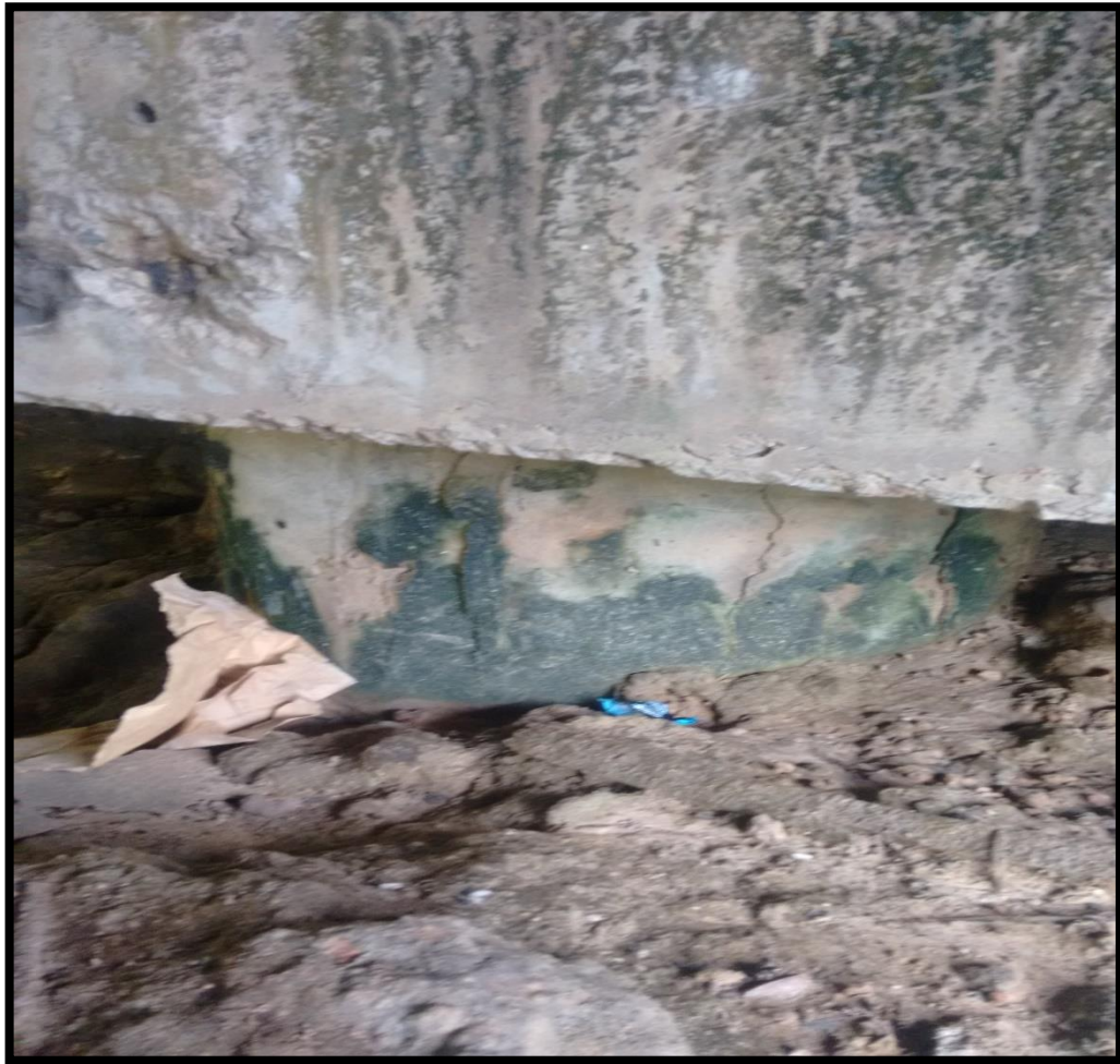
Figura 19. Trinca no pilar da ponte que fica em constante contato com a água do mar
