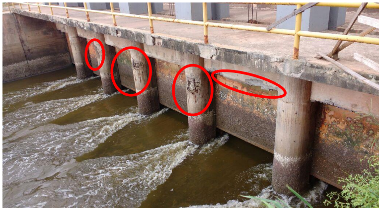
Figura 15 -Pontos de corrosão na estrutura de concreto armado da barragem do rio Bacanga -Foto: O autor
