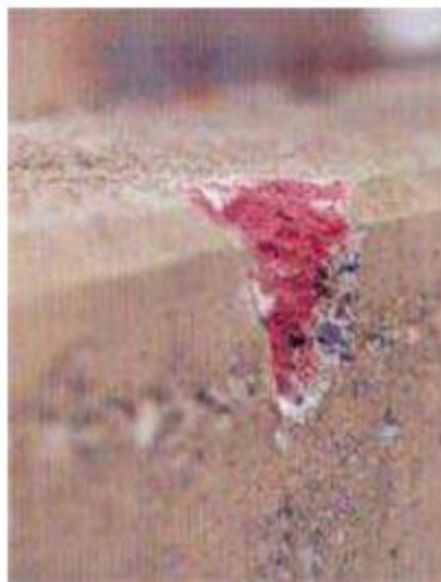
Figura 9- Teste de carbonatação no concreto armado com solução de fenolftaleína. (HORMIGONELABORADO.COM)
