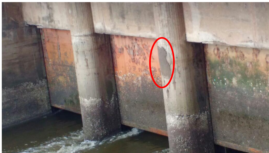
Figura 16 -Desprendimento do reboco na estrutura de concreto armado da barragem do rio Bacanga -Foto: O autor
