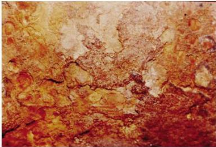
Figura 5- Corrosão Uniforme em Chapa de Aço Carbono (GENTIL, V 2007)
