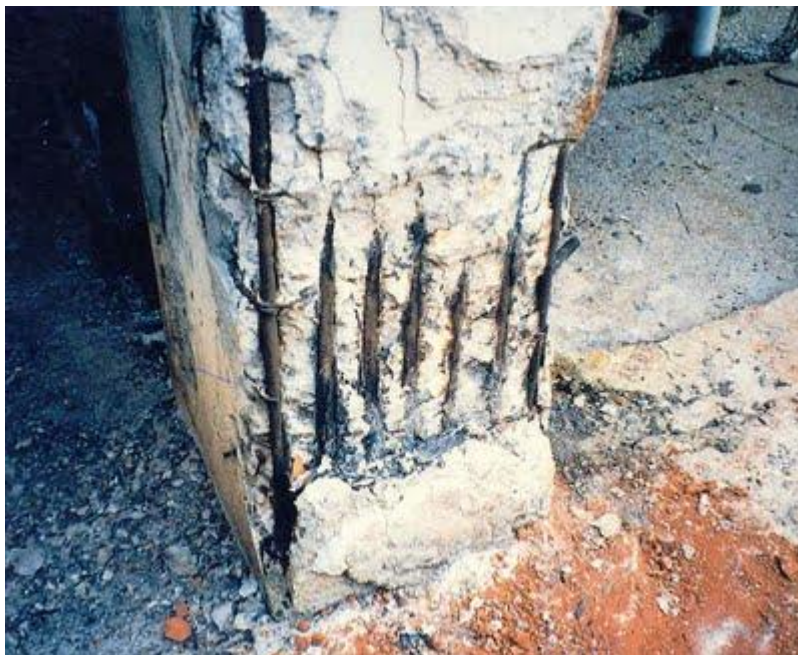
Figura 11 -Corrosão na armadura de aço do concreto
