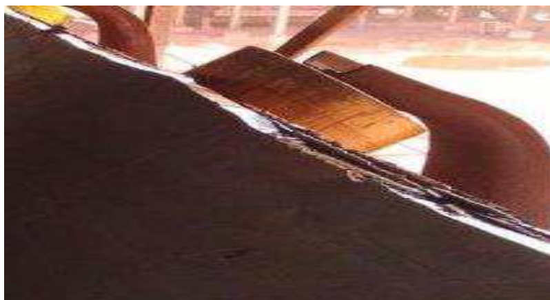
Figura 11 – Correia perdendo borda devido ao desalinhamento
