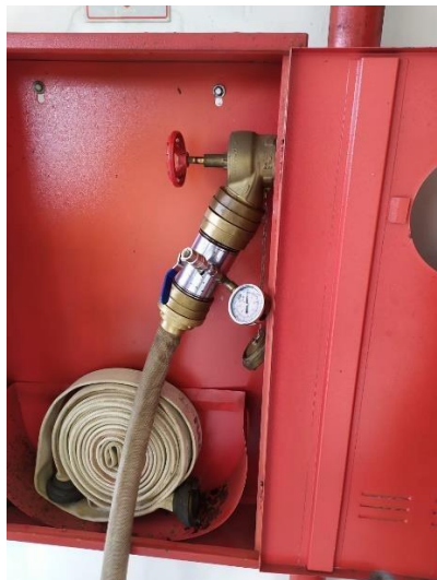
Figura 58 - Pressão na saída da válvula de hidrante
