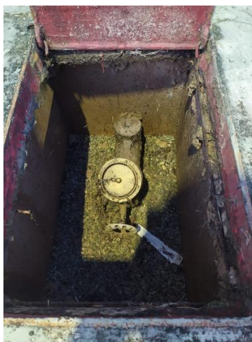
Figura 34 - Hidrante de recalque
