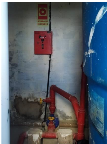
Figura 47 - Bomba de Incêndio
