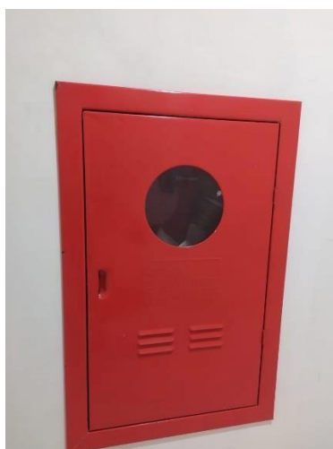
Figura 46 - Hidrante de Parede
