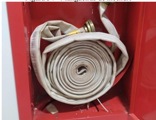
Figura 54 - Mangueiras de incêndio
