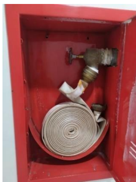
Figura 35 - Hidrante de Parede
