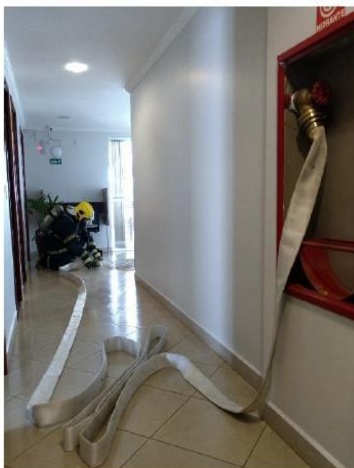
Figura 48 - Mangueira conectada ao hidrante de parede
