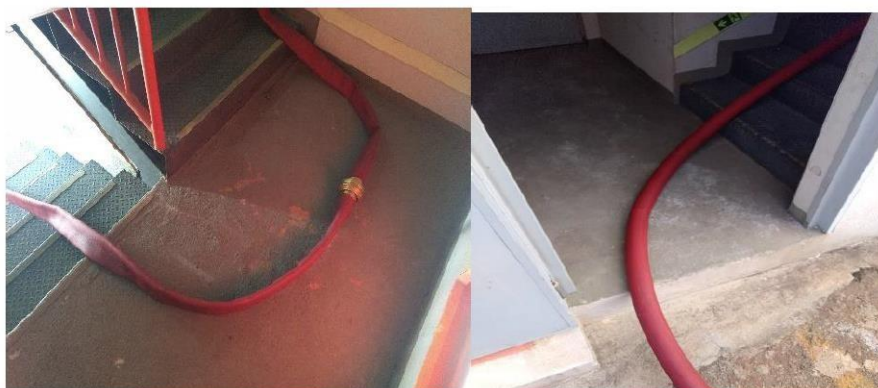
Figura 49 - Mangueiras ao longo da caixa de escadas
