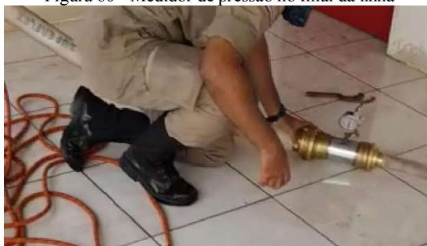
Figura 60 - Medidor de pressão no final da linha
