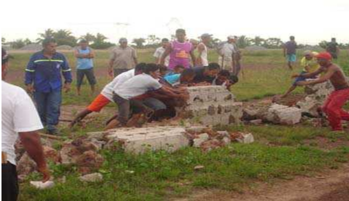
Figura 15 - A queda do muro de Bacabeira-MA.
