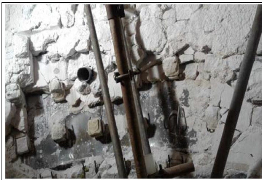
Figura 15 – Elevado desgaste encontrado na inspeção do refratário da região do cone do forno do Calcinador.
