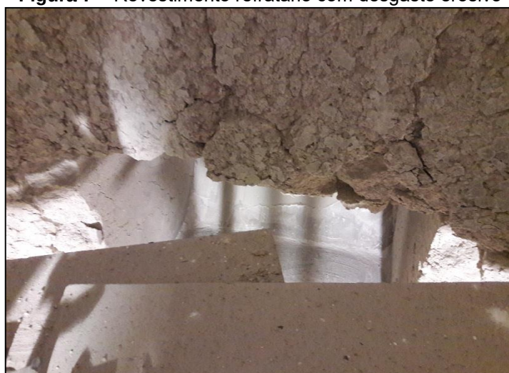
Figura 7 – Revestimento refratário com desgaste erosivo
