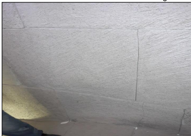
Figura 4 – Painéis de concreto refratário com desgaste erosivo
