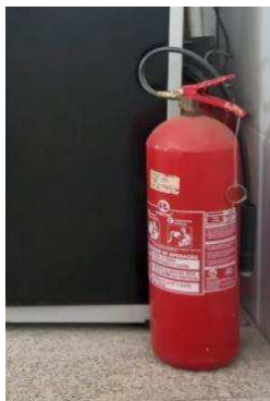
Figura 14. Representação de extintor de incêndio de uma das escolas pesquisada.
