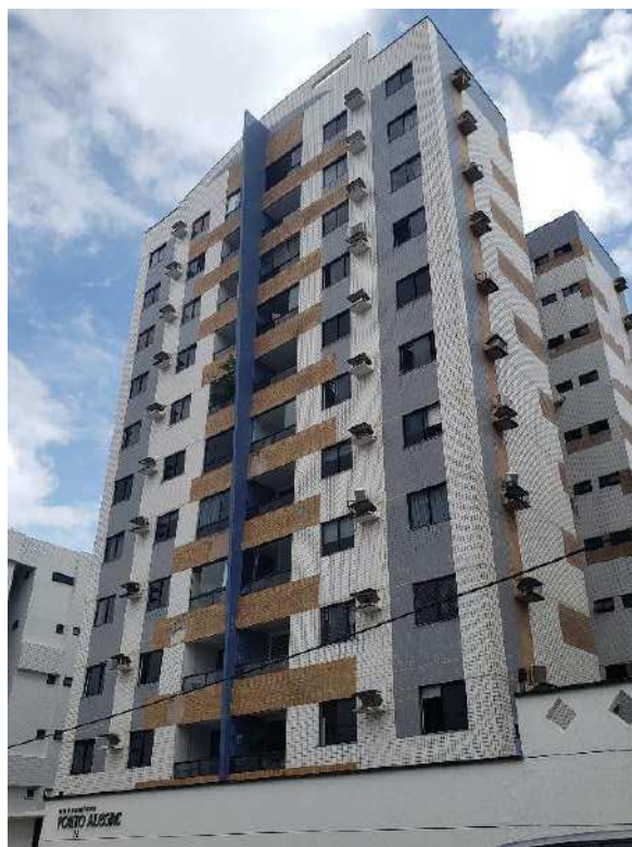
Figura 13: Marcações de áreas danificadas na fachada em formato retangular, no Condomínio Porto Alegre. Fonte: Autor, 2024.
