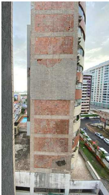
Figura 24: Substrato quase completamente exposto, em fachada lateral do Ed. Maison Classic. Fonte: Autor, 2024.
