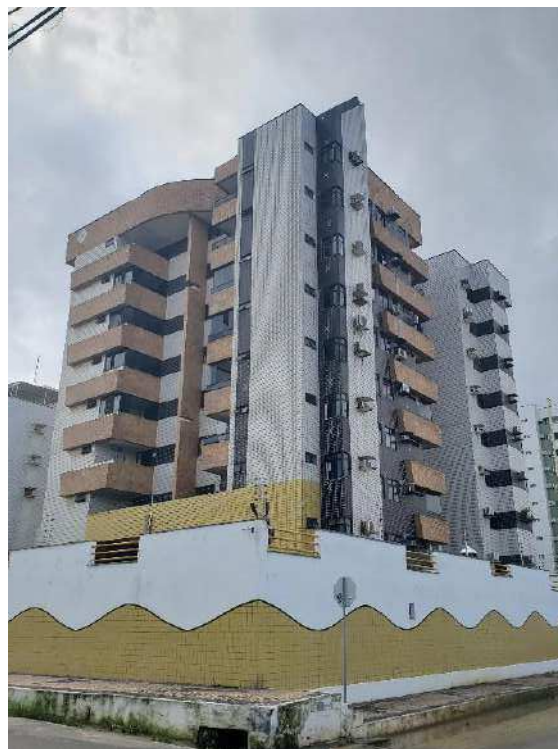
Figura 12: Marcações de áreas danificadas na fachada em formato de "X" no Ed. Portal da Lagoa. Fonte: Autor, 2024.
