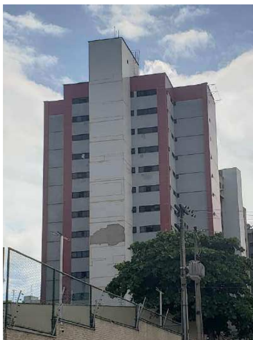
Figura 15: Demarcação na área de transição entre pavimentos, em fachada de fundo do Ed. Delos. Fonte: Autor, 2024.
