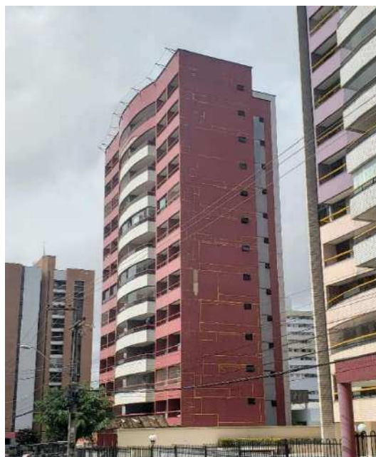
Figura 14: Demarcação na área de transição entre pavimentos, em fachada lateral do Ed. Delos. Fonte: Autor, 2024.
