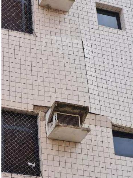
Figura 22: Descolamento das placas cerâmicas (estufamento), em fachada do Ed. Maison Classic. Fonte: Autor, 2024.
