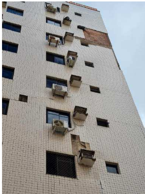
Figura 23: Colapso do emboço, em fachada do Ed. Maison Classic. Fonte: Autor, 2024.
