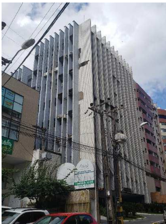
Figura 9: Descolamento cerâmico no Ed. Manhattan. Fonte: Autor, 2024.
