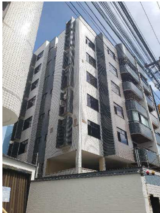
Figura 8: Descolamento cerâmico no Ed. Florença. Fonte: Autor, 2024.
