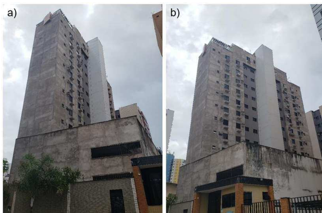
Figura 26: Fachada de fundo do Ed. Maison Classic com nova camada de emboço executada. Fonte: Autor, 2024.
