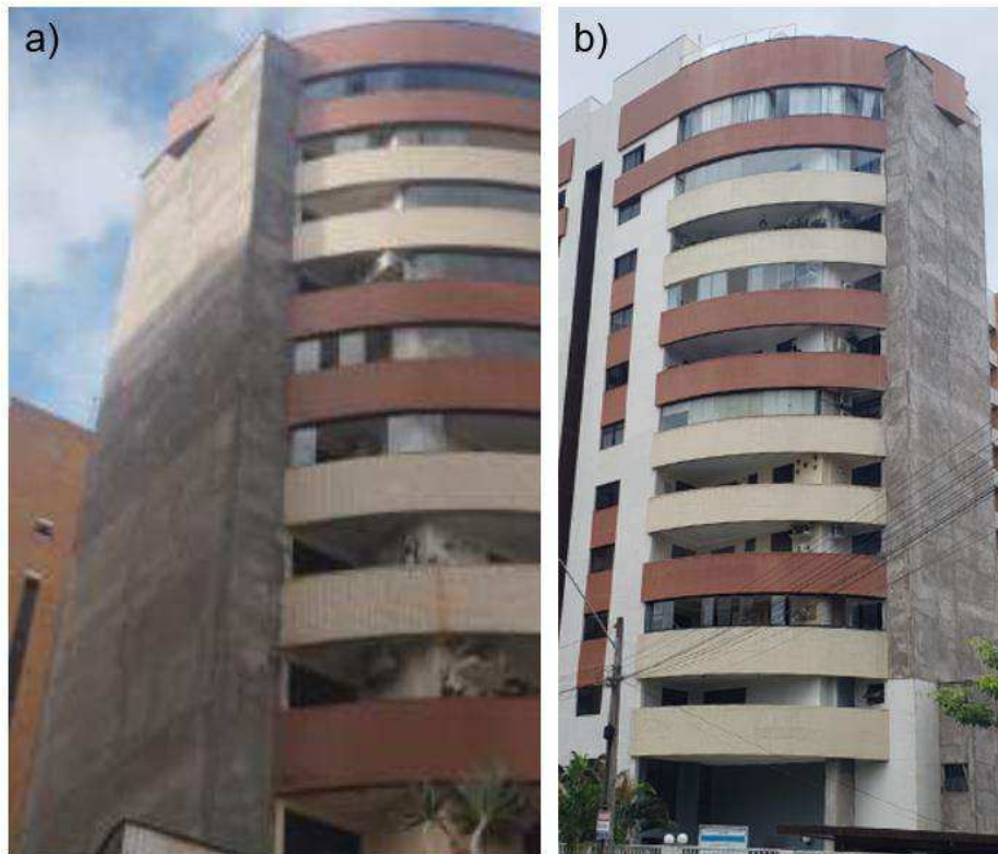
Figura 27: Fachadas lateral esquerda e direita do Ed. Maison Classic com nova camada de emboço executada. Fonte: Autor, 2024.
