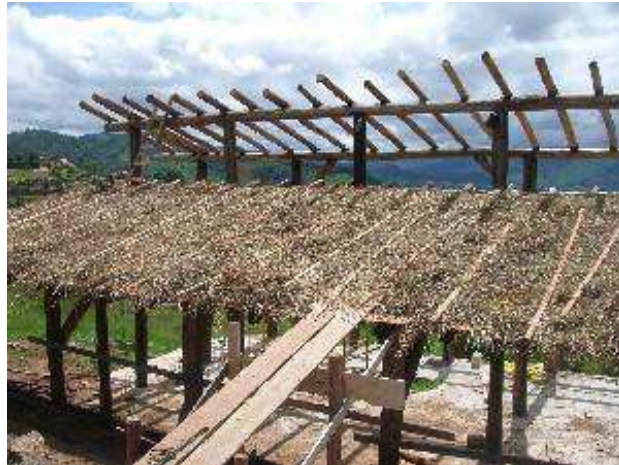
Figura 15. Construção de Telhado Verde em estrutura de Madeira – 1ª Etapa. Fonte: PlanetaSustentávelAbril.com, 2009.
