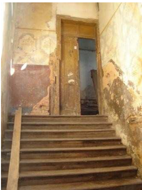
Figura 39: Detalhe escada a partir do patamar que dá acesso ao 3º pavimento
