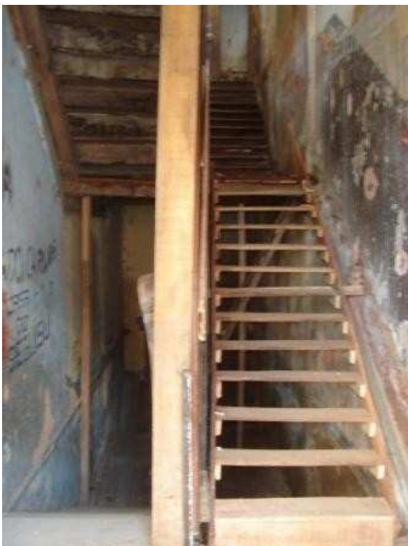
Figura 41: Detalhe escada a partir do patamar que dá acesso ao 2º pavimento
