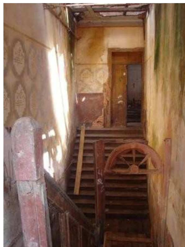
Figura 40: Detalhe escada a partir do patamar que dá acesso ao 3º pavimento
