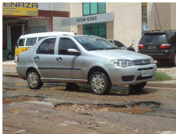
Figura 12: Impacto das águas correntes na pavimentação asfáltica.
