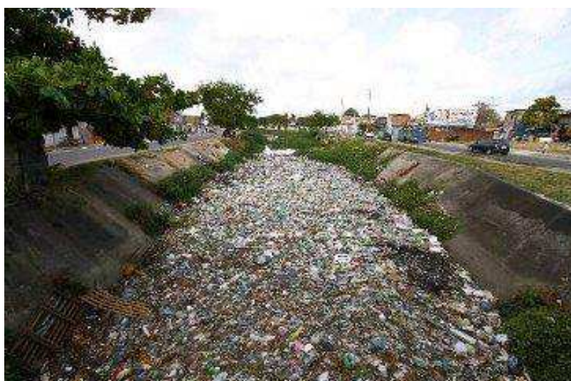
Figura 7: Canal Arruda em Recife, equipamento de drenagem urbana, é comprometido pelo lançamento de esgoto sem tratamento e depósito de lixo em 2013.
