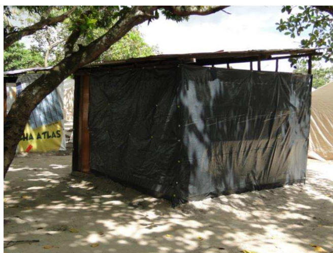
Figura 37: “Casa provisória” feita pelos moradores com madeira, lona e telha de fibrocimento. Detalhe para o espaço entre as “paredes” e teto.
