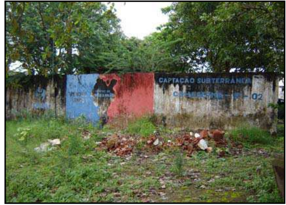
Foto 7: Detalhe da Estação de Captação Subterrânea da CAEMA.
