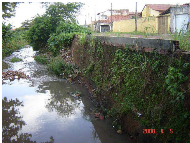
Figura 16 - Parede de contenção que ultrapassa o limite de 5m de recuo do rio
