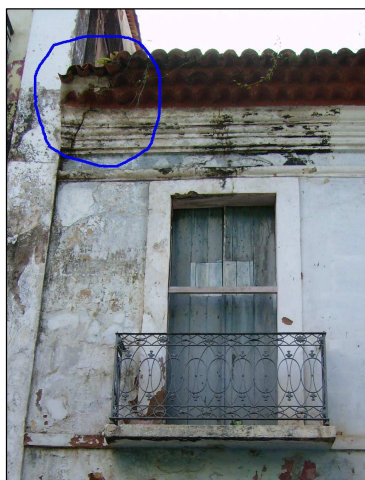
Fig. 33 – Telhas e beira-seveira dupla danificadas.
