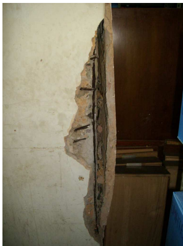
Fig. 39 – Pilar P7 com armação de ferro oxidada. Fonte: Hilbert Brunno, 2006.
