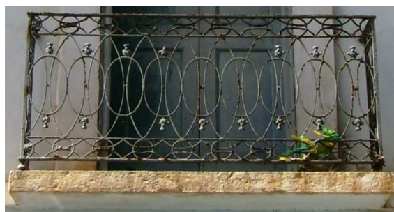
Fig. 20 – Gradil de ferro da esquadria nº. 11. Fonte: Hilbert Brunno, 2006.
