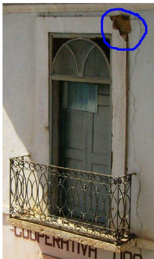
Fig. 10 – Verga de madeira exposta sob a esquadria nº 09. Fonte: Hilbert Brunno, 2006.
