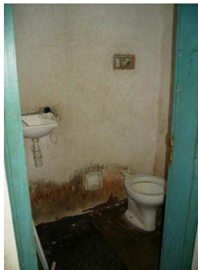
Fig. 23 – Banheiro de funcionários sem chuveiro. Fonte: Hilbert Brunno, 2006.
