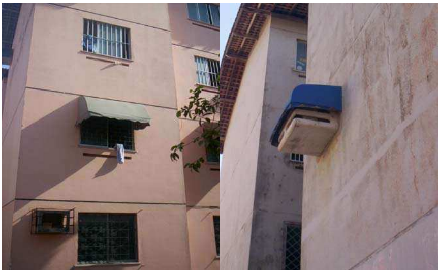
Figura 106 – Acréscimo de toldo na fachada, bem como capa para caixa de ar condicionado Fonte: Acervo pessoal, 2007.
