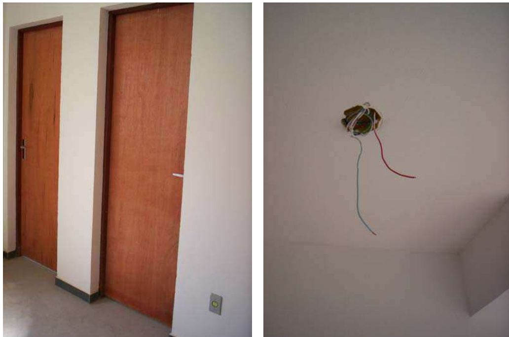
Figura 133 – Sala de apartamento apresentando somente cimentado liso, bem como a falta do bocal para lâmpada no teto
