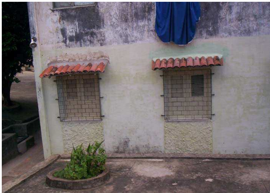
Figura 85 – Adaptação feita pelo morador, solução criada para a proteção das esquadrias de madeira Fonte::Acervo pessoal,2007.
