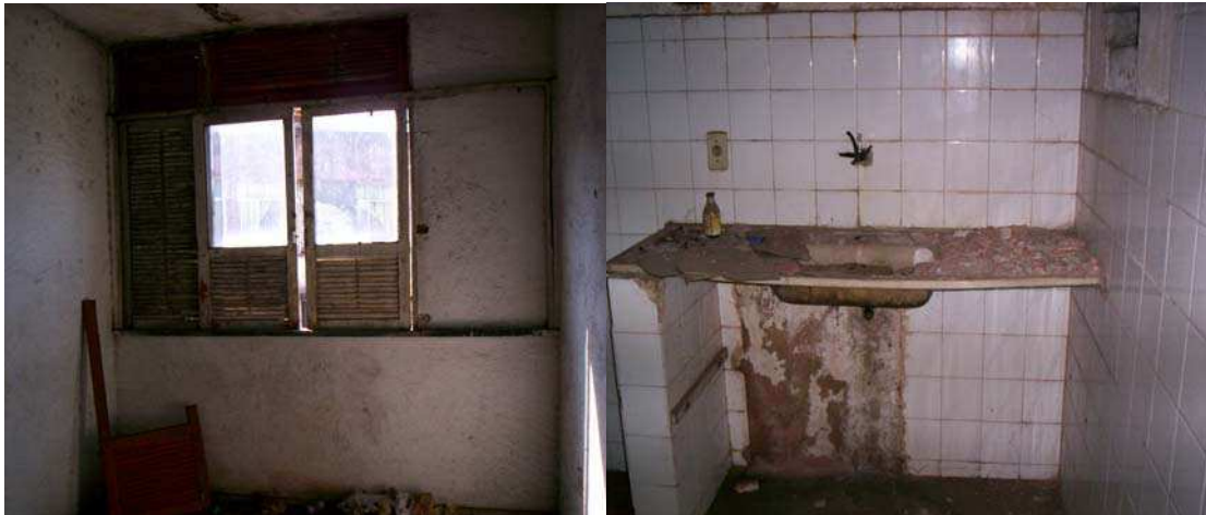
Figura 65 – Descaracterização causada pelo abandono do apartamento Fonte: Acervo pessoal,2007
