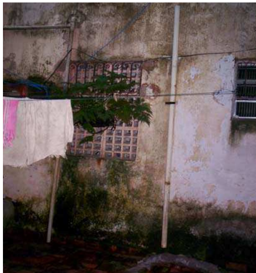
Figura 75- Área interna de bloco residencial apresentando tubulação de esgoto aparente e derramando material orgânico sobre área externa Fonte:Acervo pessoal,2007.
