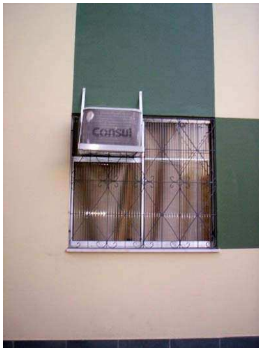
Figura 131 – Aparelho de ar condicionado passando pela esquadria de alumínio Fonte: Acervo pessoal, 2007.
