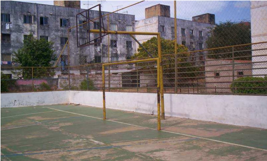
Figura 79- Quadra esportiva em precárias condições Fonte: :Acervo pessoal,2007.
