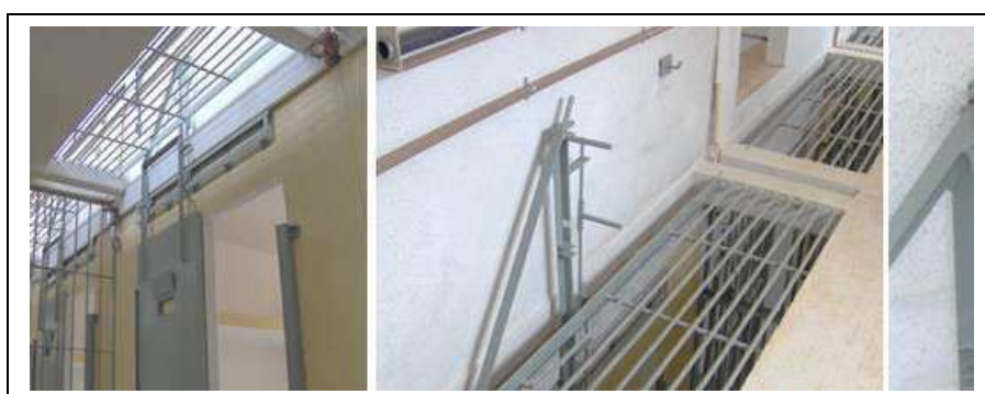
Figura 19 – Detalhes da porta do módulo de celas (instalado), com sistema de abertura via passarela aérea e mecanismo de travamento da porta.
