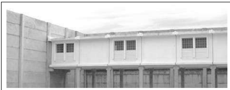
Figura 13 – Módulo de passarela utilizados fora do contexto das galerias de celas.
