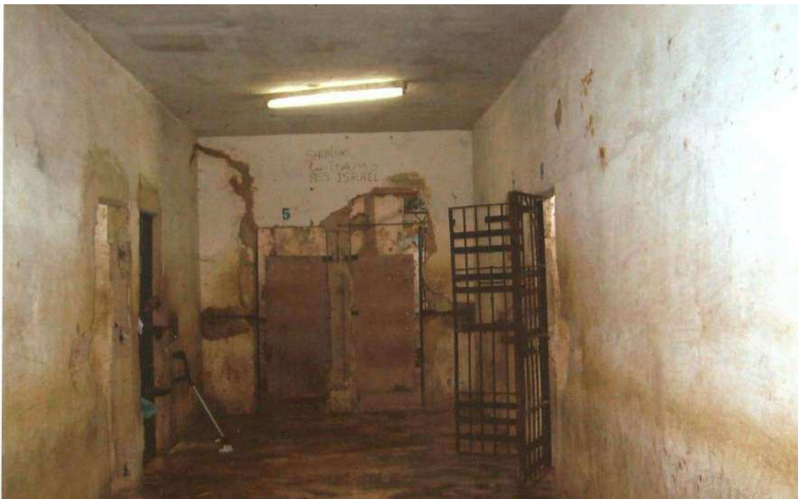
Figura 29 – Corredor de acesso as celas do Bloco E da Casa de Detenção.
