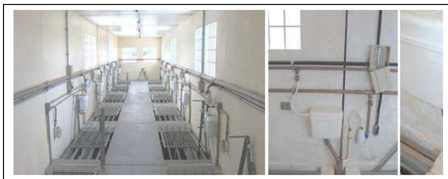
Figura 20 – Conjunto de controle de um módulo (aquecedor, descarga e luz).
