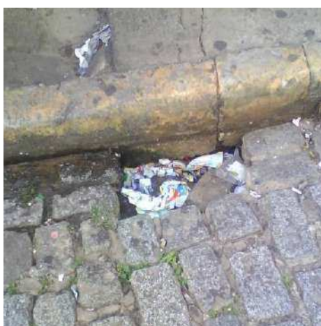
Pedras deslocadas problemas na drenagem
