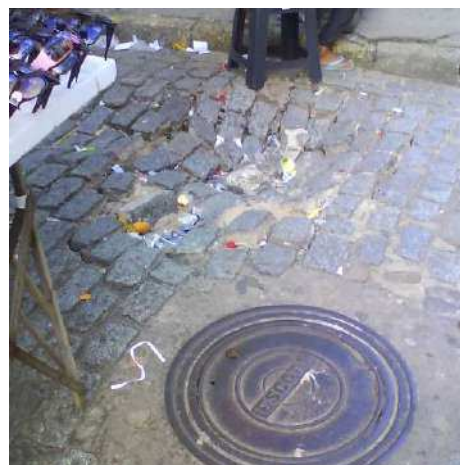
Trecho do calçamento afundado
