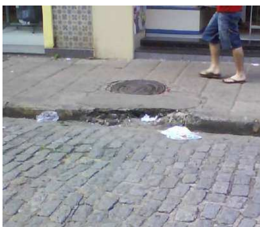
Tampa danificada e entrada obstruída
