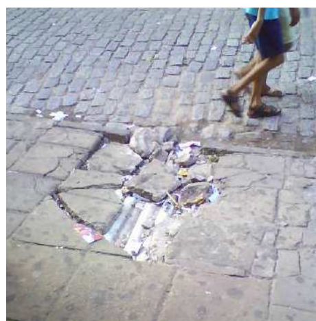
Má execução causa danos à calçada
