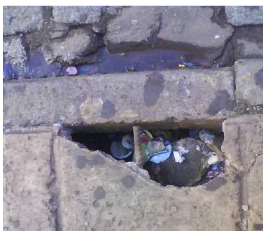
Buraco revela o acúmulo de lixo na galeria
