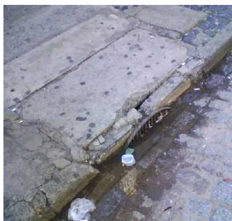
Tampa mal colocada atrapalha o trânsito
