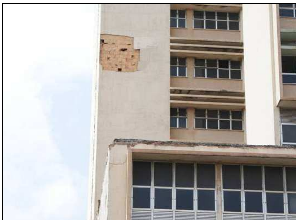
Figura 39 – Degradação do Edifício João Goulart
