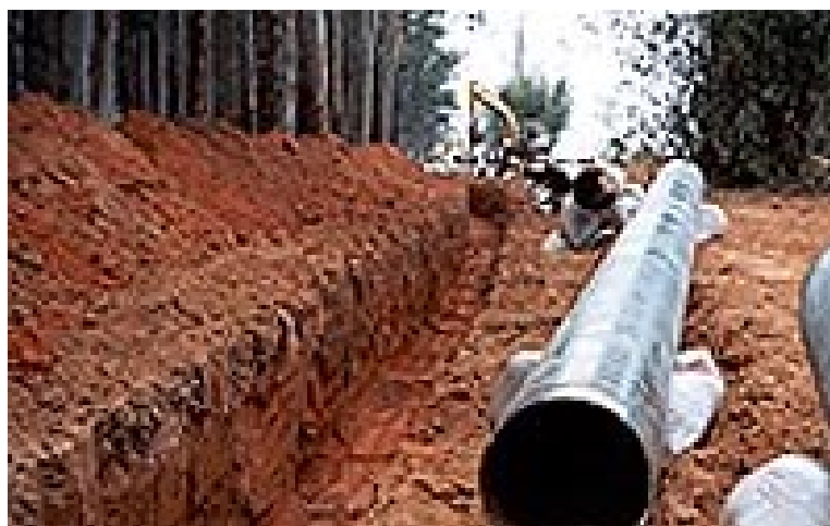
Figura 12 – Tubulação de Gás Natural Fonte: www.gasnaturalsps.com.br
