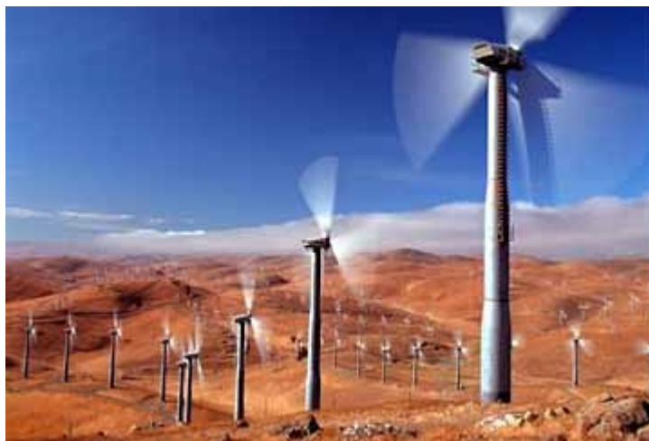
Figura 6 – Geradores de Energia Eólica Fonte: www.eolica.com.br
