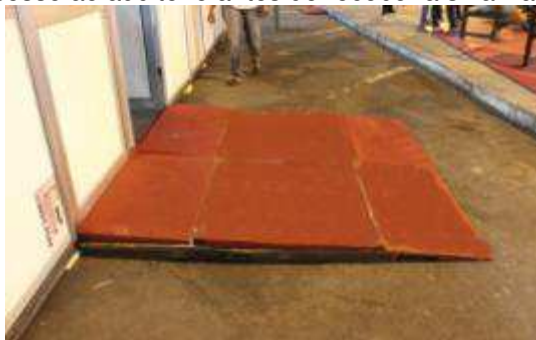
Figura 59 - Rampa de acesso ao auditório antes de receber a sinalização e proteção na lateral.
