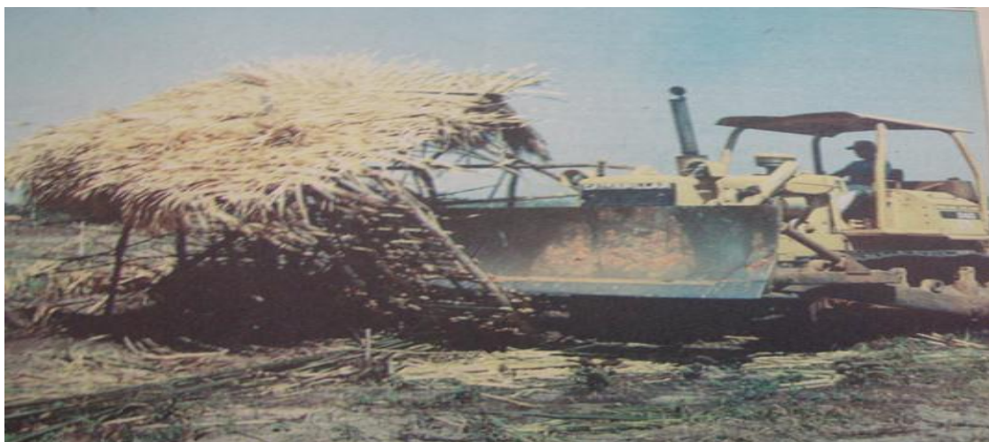
FIGURA 1 – Trator derrubou centenas de casebres na Cidade Olímpica.
