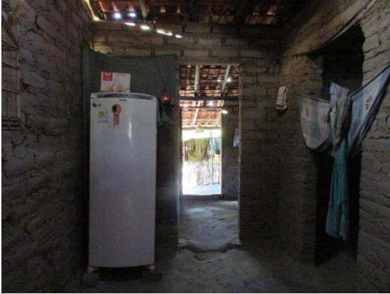
Figura 51: Copa com geladeira. Cortina de tecido em frente à abertura do quarto. Nota-se também o chão em terra batida. Fonte: LATESE, 2017.
