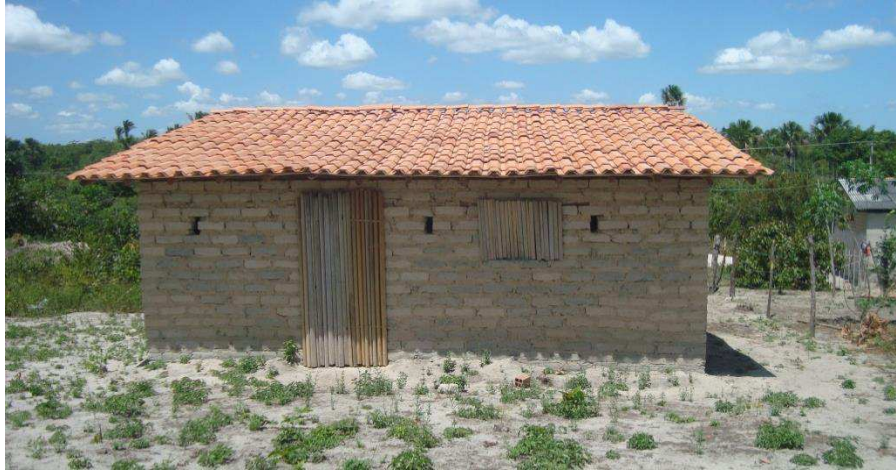
Figura 31: Casa de adobe não revestido, com cobertura de telha cerâmica e esquadrias feitas de ripas de madeira. Fonte: LATESE, 2016.
