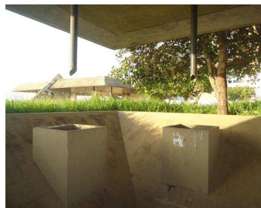
Figura 57 - Vista interna da floreira coletora de água pluvial de um dos volumes do Memorial Bandeira Tribuzi. Fonte: CUNHA, 2014.
