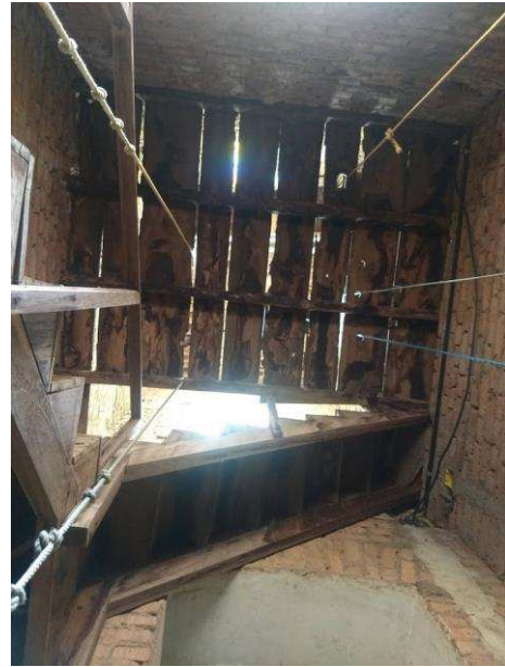
Figura 42: Vista de baixo para cima do campanário. Esta parte da construção foi a única a nunca sofrer uma intervenção. (Fonte: ARQUIVO PESSOAL, 2019).
