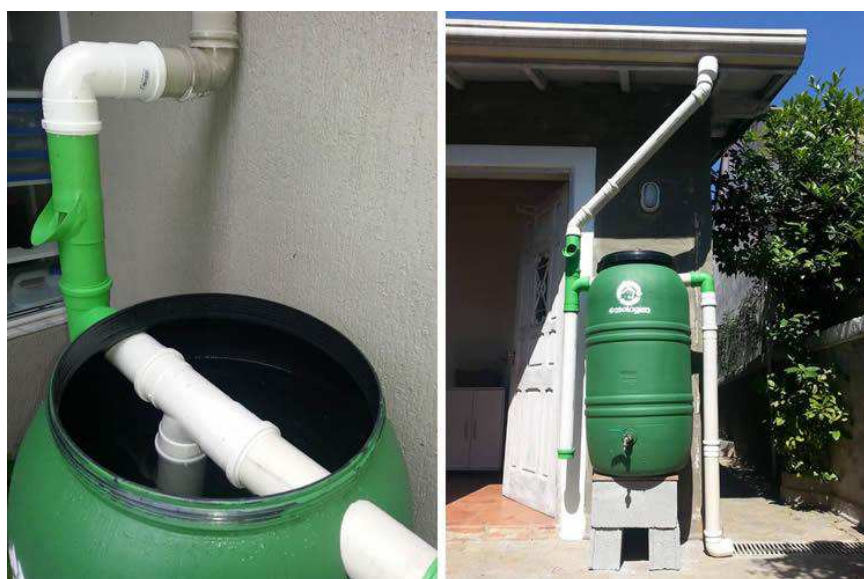
Figura 42 - Exemplo de reservatório
