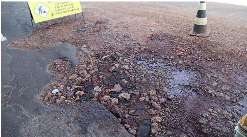
Figura 13 – Bairro do Santo Antônio: Patologias na pavimentação. https://oestadoma.com/noticias/2016/07/23 (Último acesso 26/10/2019)
