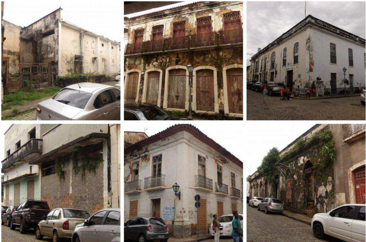
Figura 12. Casarões da Praia Grande em estado de abandono e/ou em ruína
