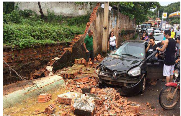
Foto 68 - Muro do Lítéro Desabou em Abril de 2017 Após Fortes Chuvas
