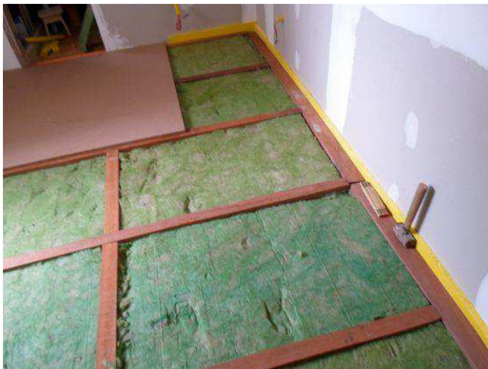
Figura 6. Piso Flutuante Fonte: Site Habitíssimo, 2018.
