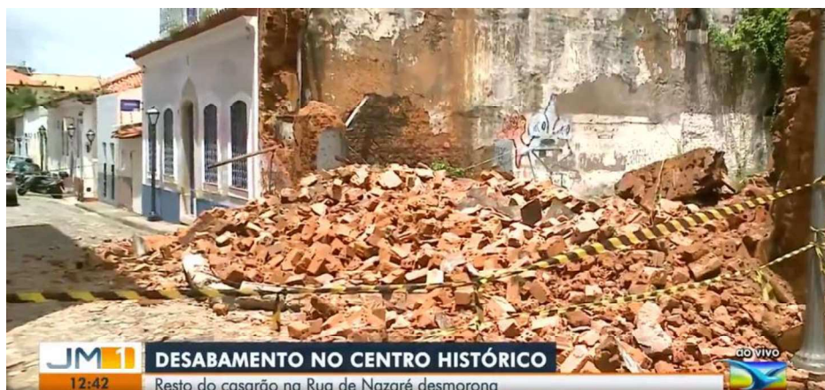
Figura 20 - Desabamento de Casarão na Rua de Nazaré, 2024.
