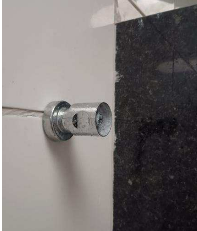
Figura 34: Registro do banheiro próximo a porta lateral do auditório
