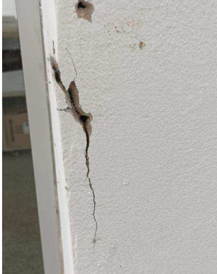
Figura 28: Trincas em pilar no anexo
