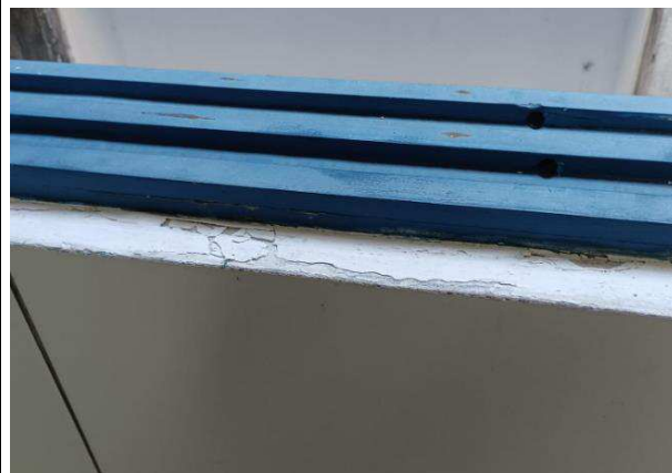
Infiltração - Banheiro feminino do segundo andar do prédio de anexo
