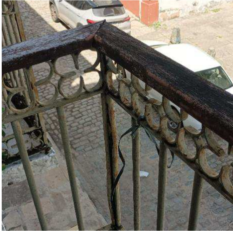
Figura 23: Imagem de guarda corpo da fachada
