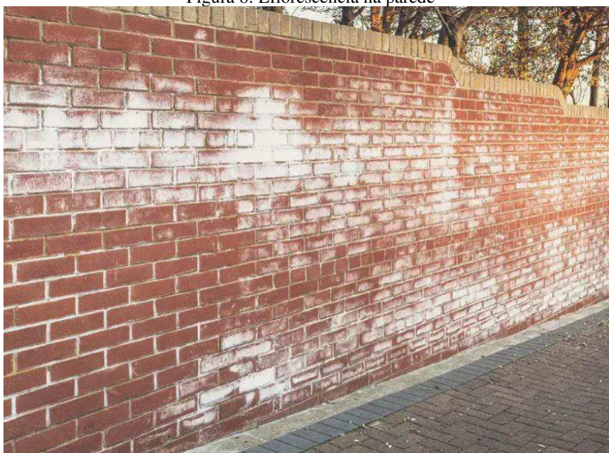
Figura 8: Eflorescência na parede
