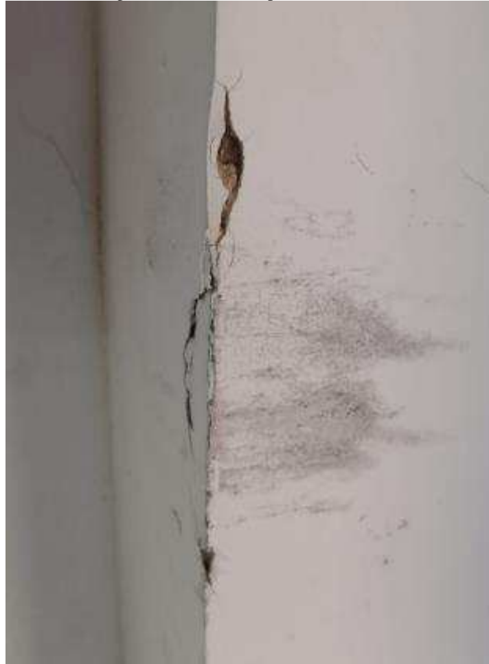
Figura 29: Trincas em pilar na biblioteca
