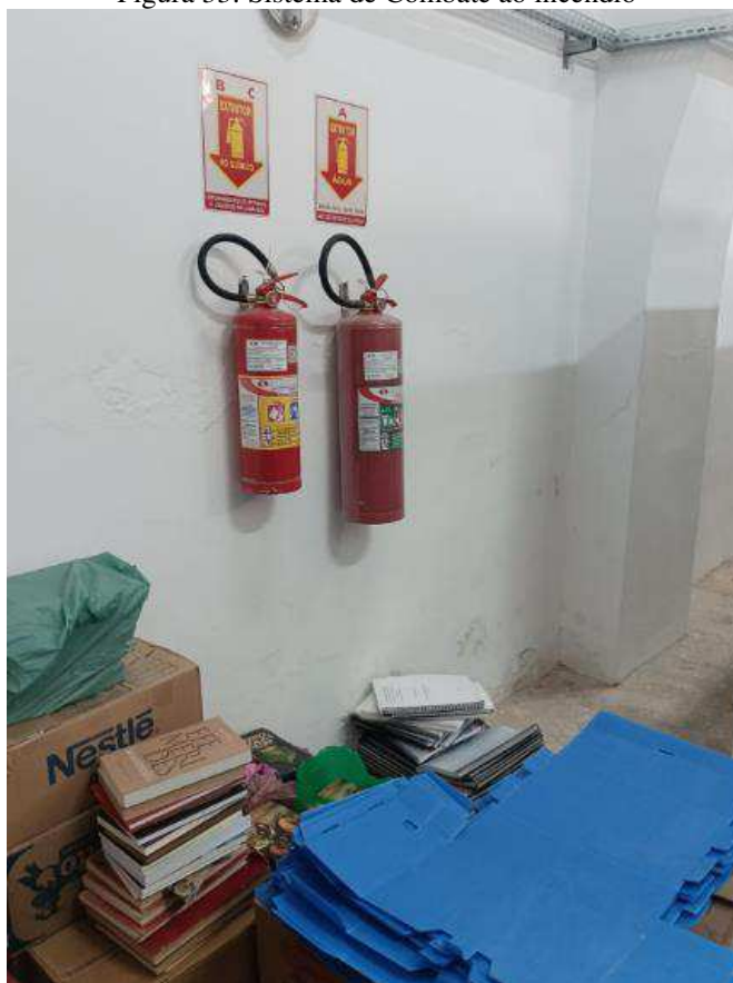
Figura 33: Sistema de Combate ao incêndio
