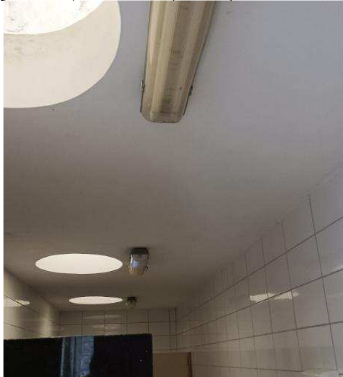
Figura 37: Lâmpadas do banheiro próximo a porta lateral do auditório
