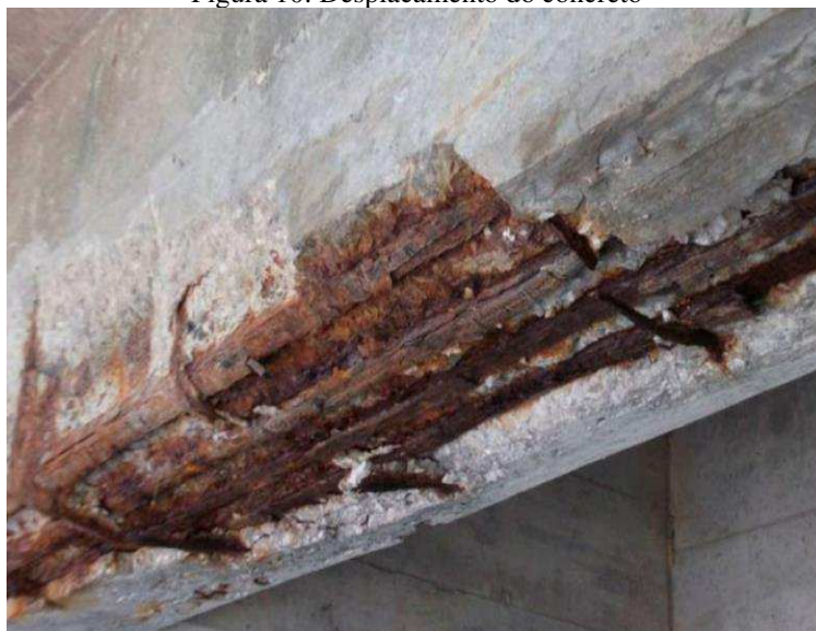
Figura 10: Deslocamento do concreto
