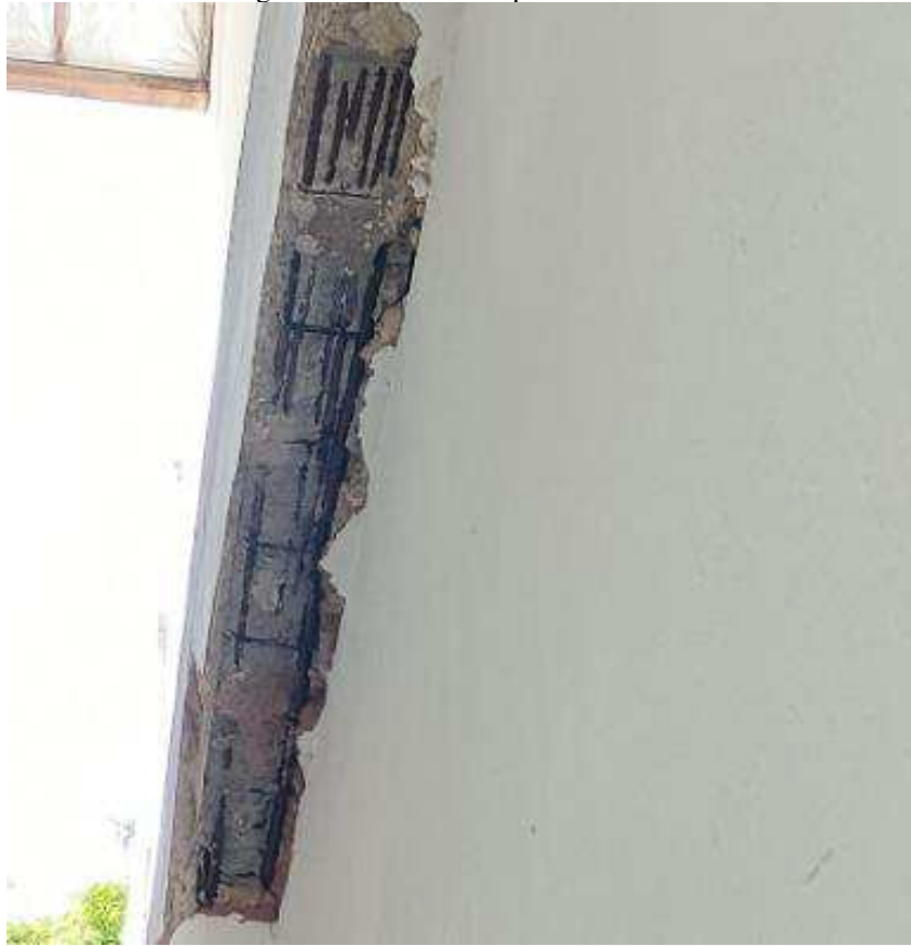
Figura 24: Armadura exposta e oxidada
