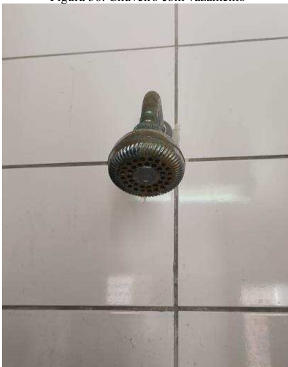
Figura 36: Chuveiro com vazamento
