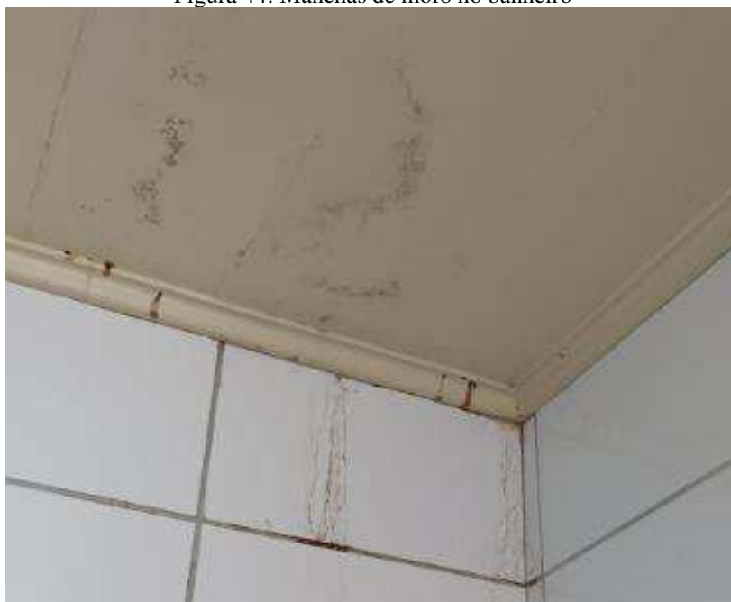
Figura 44: Manchas de mofo no banheiro
