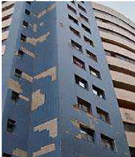
Figura 14: Falha de rejunte, Patologia na fachada lateral e posterior
