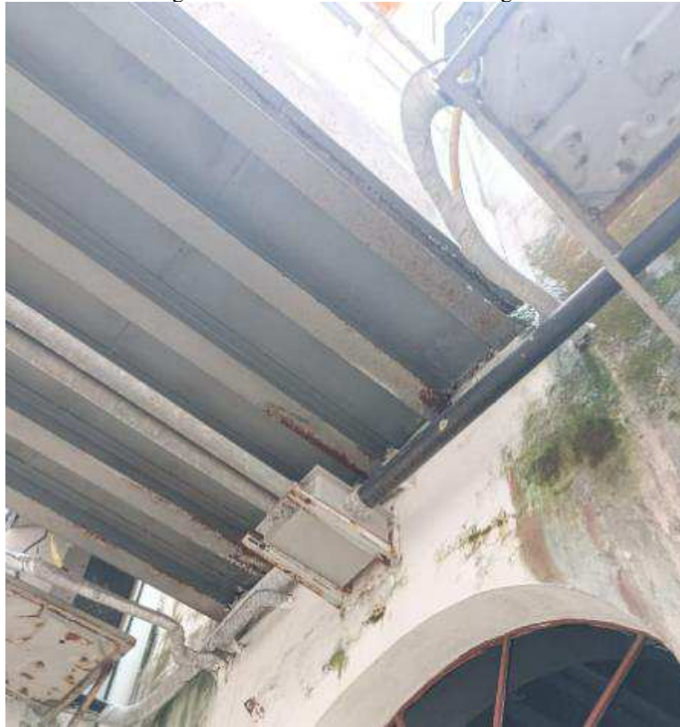
Figura 25: Ponte metálica com ferrugem
