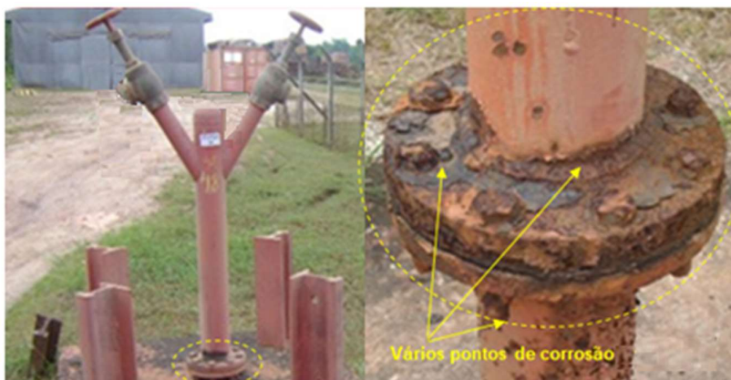
Figura 1.1 – Pontos de corrosão em hidrantes da Ferrovia. (Autores, 2021)
