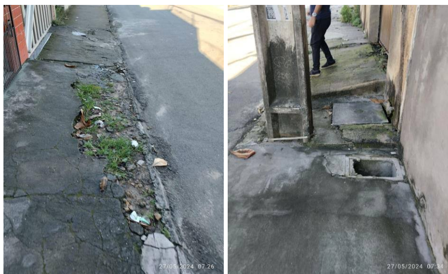
Figura 48 e 49 - Rua Um: calçamento deteriorado e obstáculos na calçada
