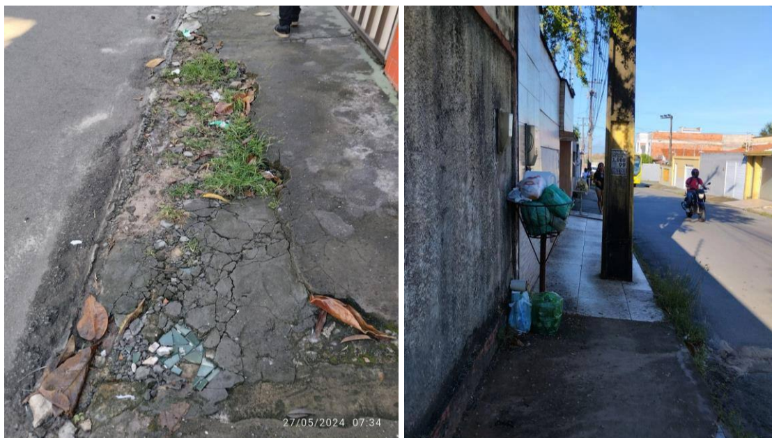
Figura 50 e 51 - Rua Um: deterioração na calçada e obstáculos na calçada
