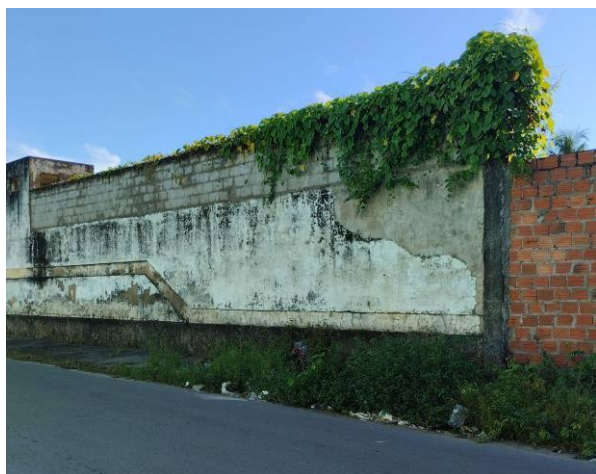
Figura 55 - Rua Doze: Obstrução de calçada
