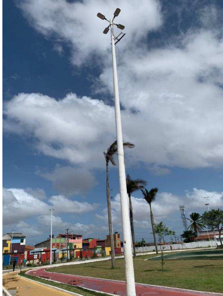
Figura 52 - Poste de iluminação
