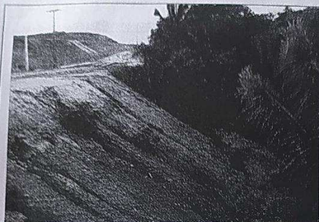
FOTO 7 – Aterro de elevação da estrada obstruindo bueiro
