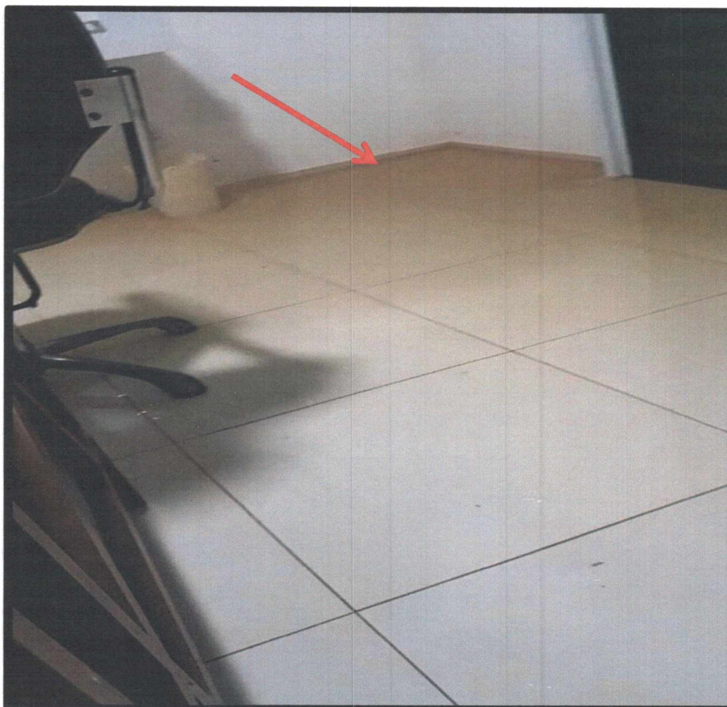
Figura 27 - Residência sendo atingida pela água em período chuvoso
