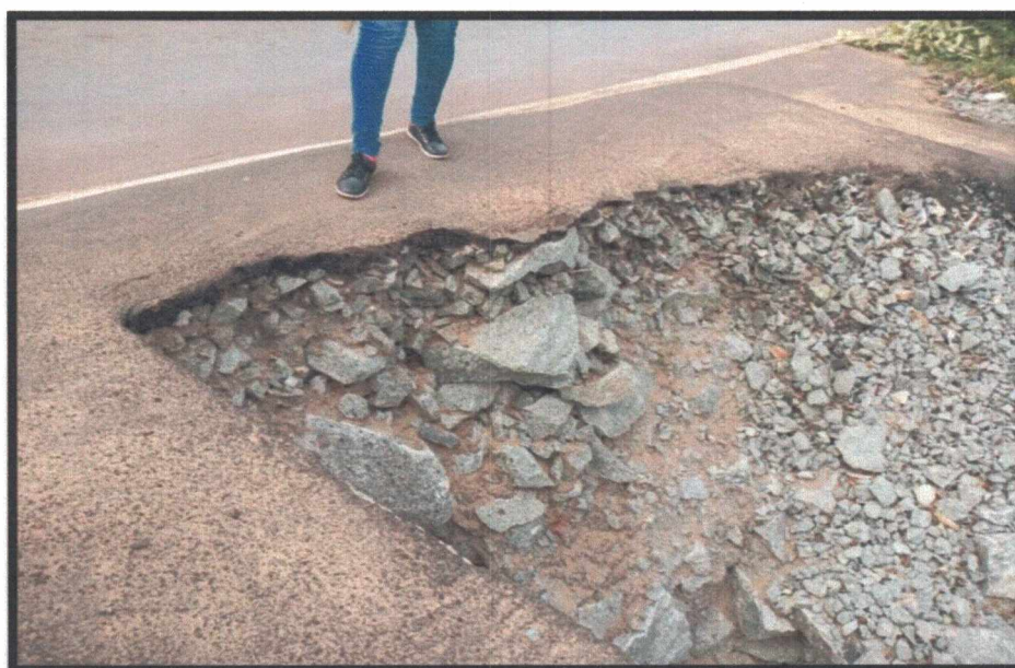
Figura 37 - Processo erosivo em avenida às margens do canal fluvial
