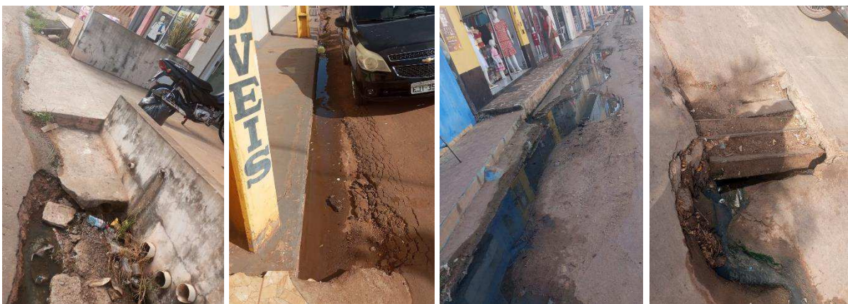
Figura 30 - Escoamento das águas pelas vias do centro de Paulo Ramos – MA
