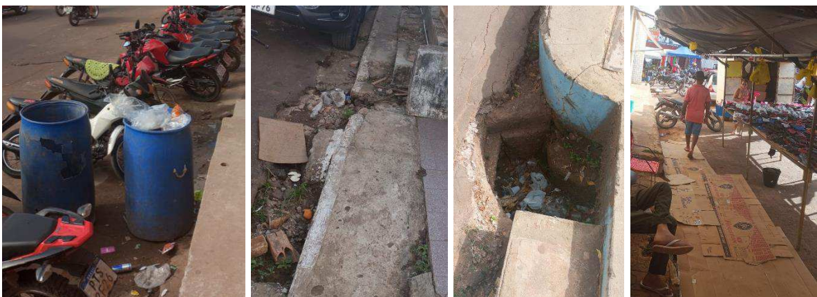
Figura 33 - Sujeiras nas ruas e nos elementos de drenagem no centro da cidade
