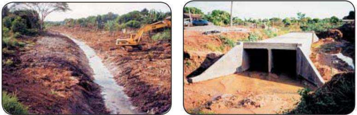
Figura 12 - Elementos naturais e artificiais da macrodrenagem, respectivamente. À esquerda, a retificação de canal natural e à direita a galeria de concreto armado
