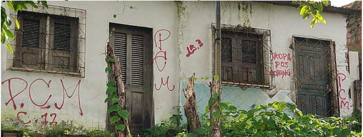
Figura 4 – Casa no Auto São Sebastião pichada com iniciais do PCM
