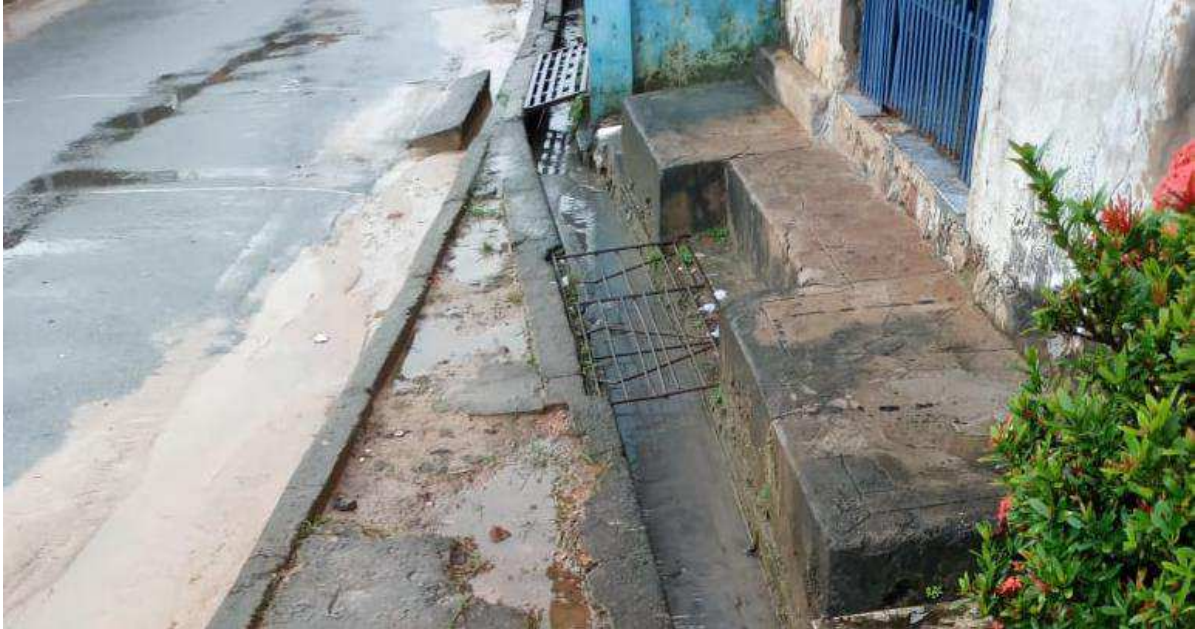
Figura 1 – Rua no Coroadinho com esgoto a céu aberto
