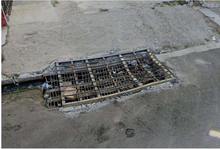
Figura 12 - Boca de lobo na rua Magalhães de Almeida.
