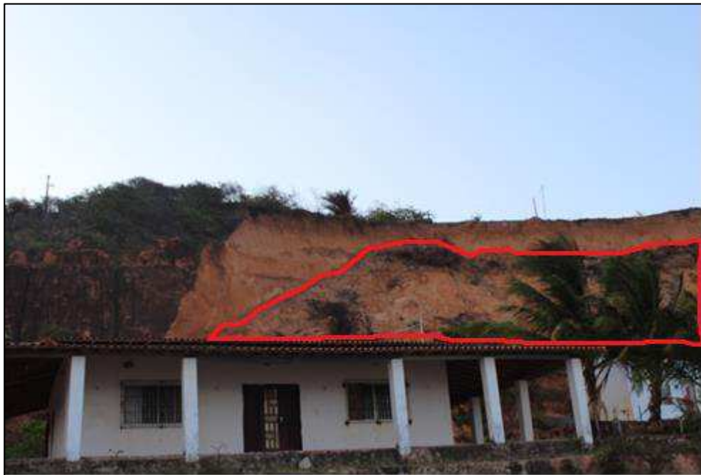
Figura 44 - Movimento de massa na falésia da praia de Ponta Verde, São José de Ribamar.
