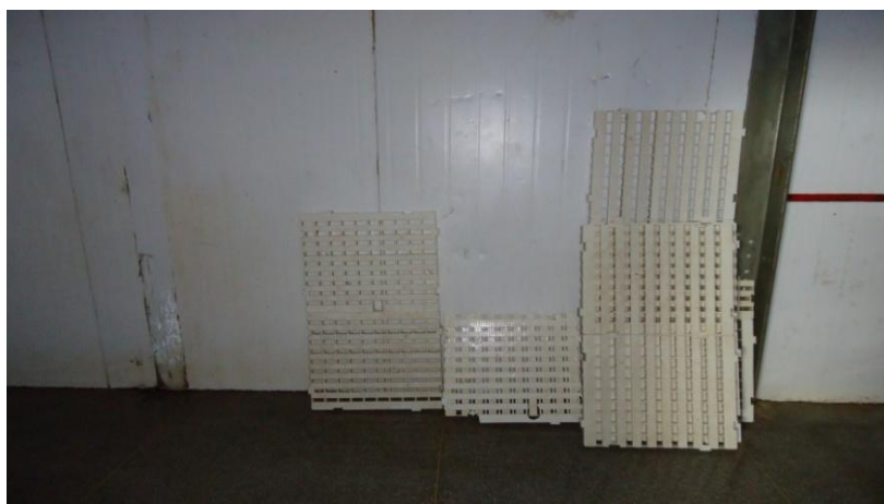
Figura 08- Entrepasto de pescado A - Edificações: paredes não higienizadas, com rachaduras e umidade.
