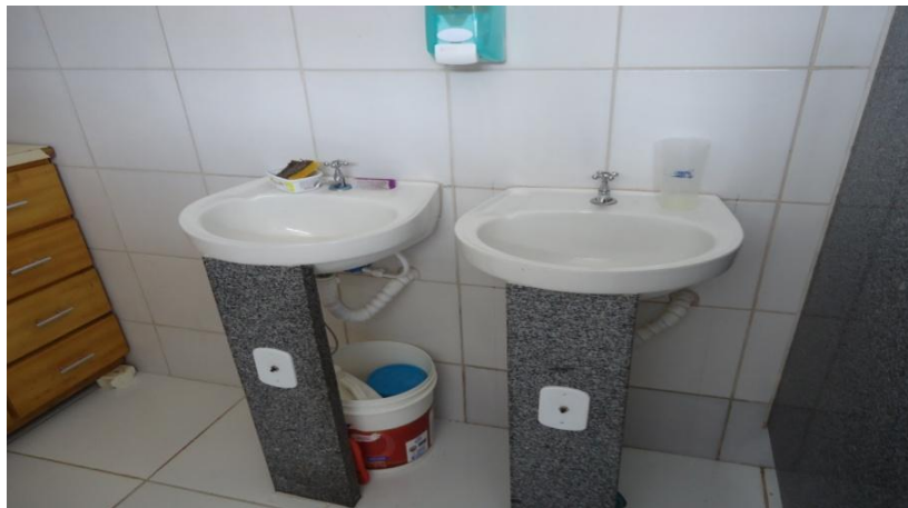
Figura 01- Entrepasto de pescado A - Instalações sanitárias e vestiários para manipuladores: sem orientação sobre a correta lavagem das mãos; não havia porta-toalhas.
