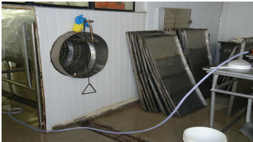
Figura 07- Entrepasto de pescado A - Edificações: paredes com rachaduras, ausência de ângulos abaulados entre as paredes e o piso e entre as paredes e o teto.
