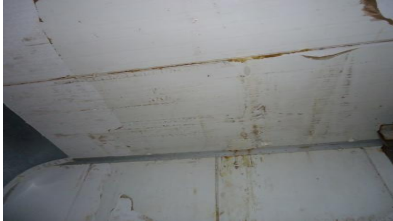
Figura 09 - Entrepasto de pescado A - Equipamentos: o teto da câmara frigorífica não estava higienizado, possuía trincas e rachaduras.
