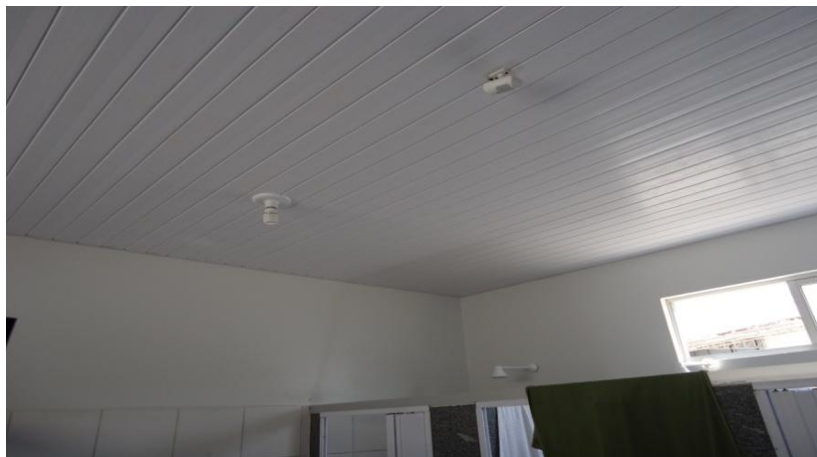
Figura 02 - Entrepasto de pescado A - Instalações sanitárias e vestiários para manipuladores: as paredes não possuíam ângulos abaulados entre paredes e o piso e entre as paredes e o teto.
