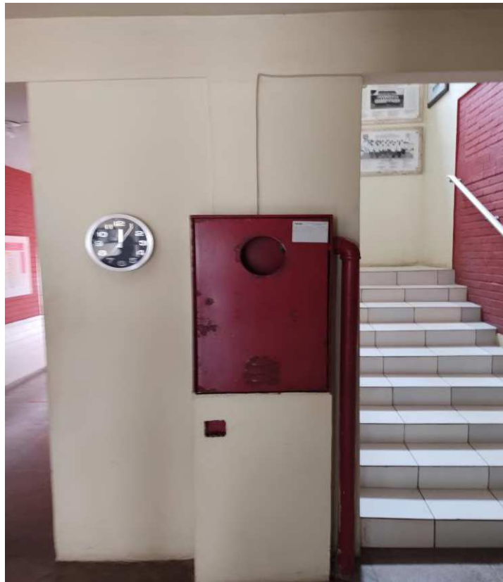
Figura 11 - Abrigo de hidrante avariado
