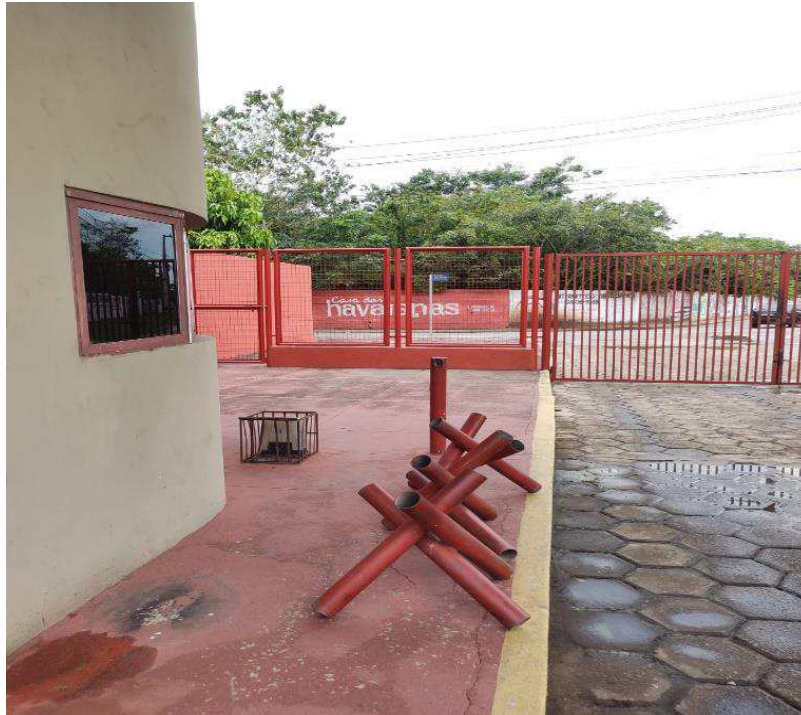
Figura 8 - Portão manual do quartel e cancela avariada
