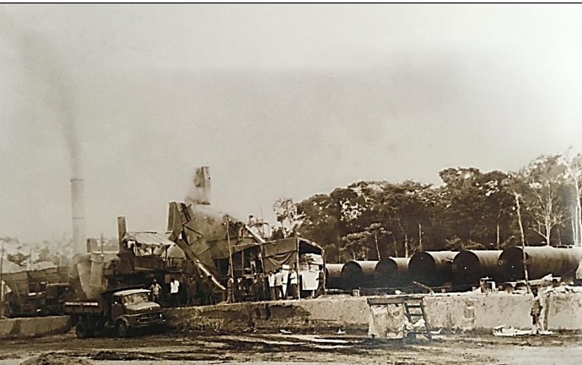
Foto da Usina de Asfalto N° 1 trabalhando no km 293 da BR-316, no qual é possível perceber todo maquinário e toda a estrutura da época usada para o processo de pavimentação asfáltica dessa rodovia.
