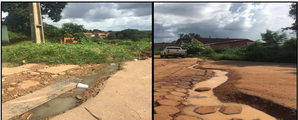
Figura 28 - Ruas com problemas de pavimentação e direcionamento de esgoto doméstico ao rebordo erosivo
