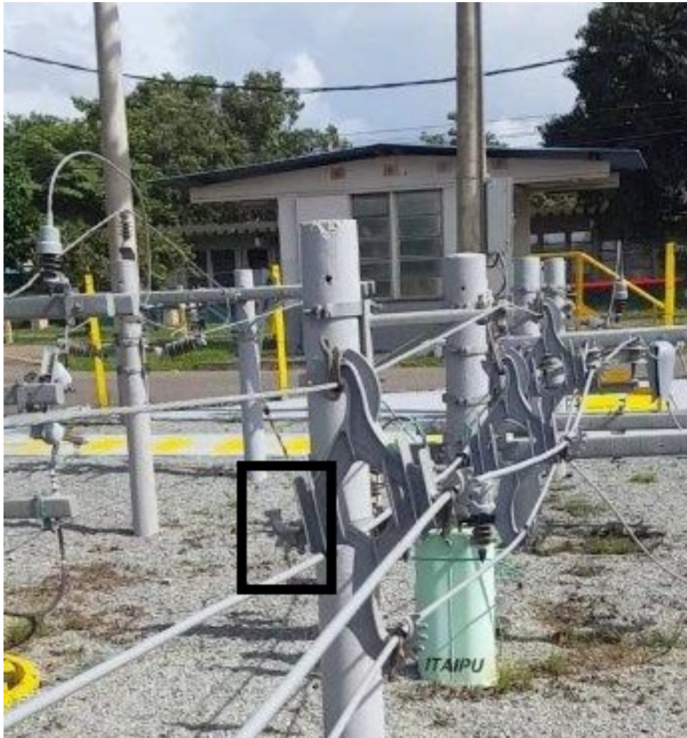
Figura 35 – Cabo fora do Espaçador
