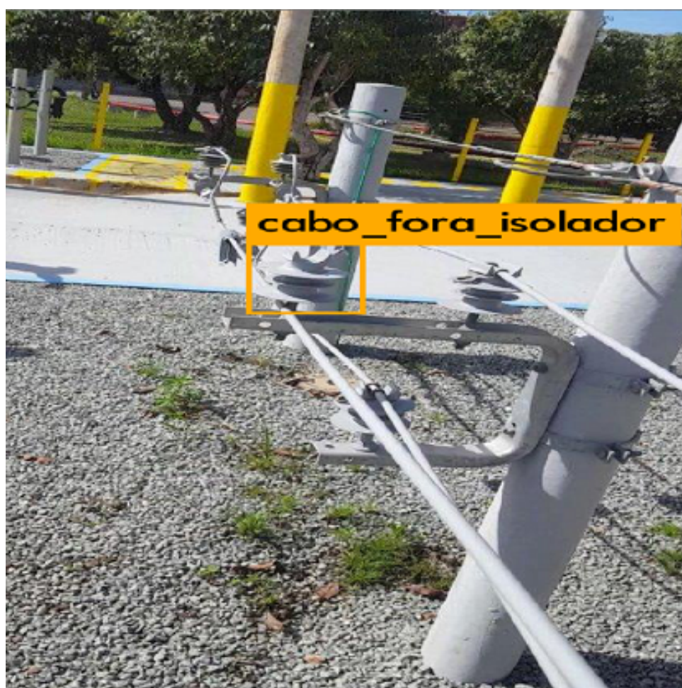
Figura 38 – Detecção Cabo Fora do Isolador
