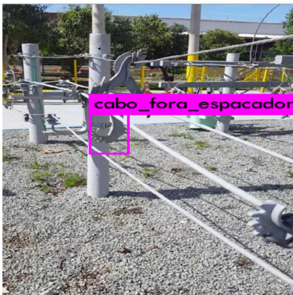
Figura 39 – Detecção Cabo Fora do Espaçador
