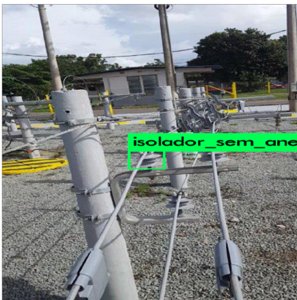
Figura 40 – Detecção Isolador sem Anel de Amarração
