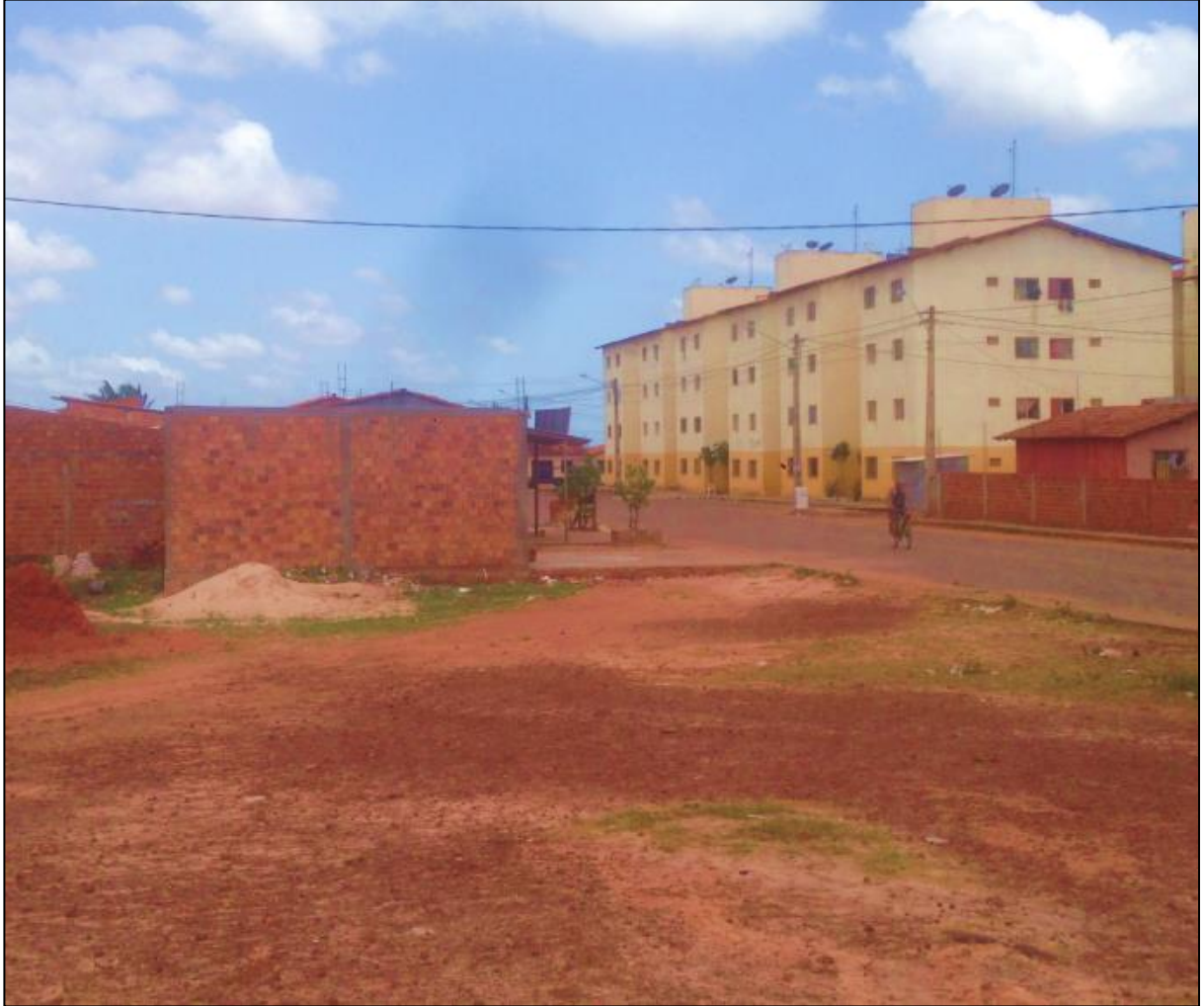
Figura 32 - Material de construção improvisado no Residencial Ribeira.
