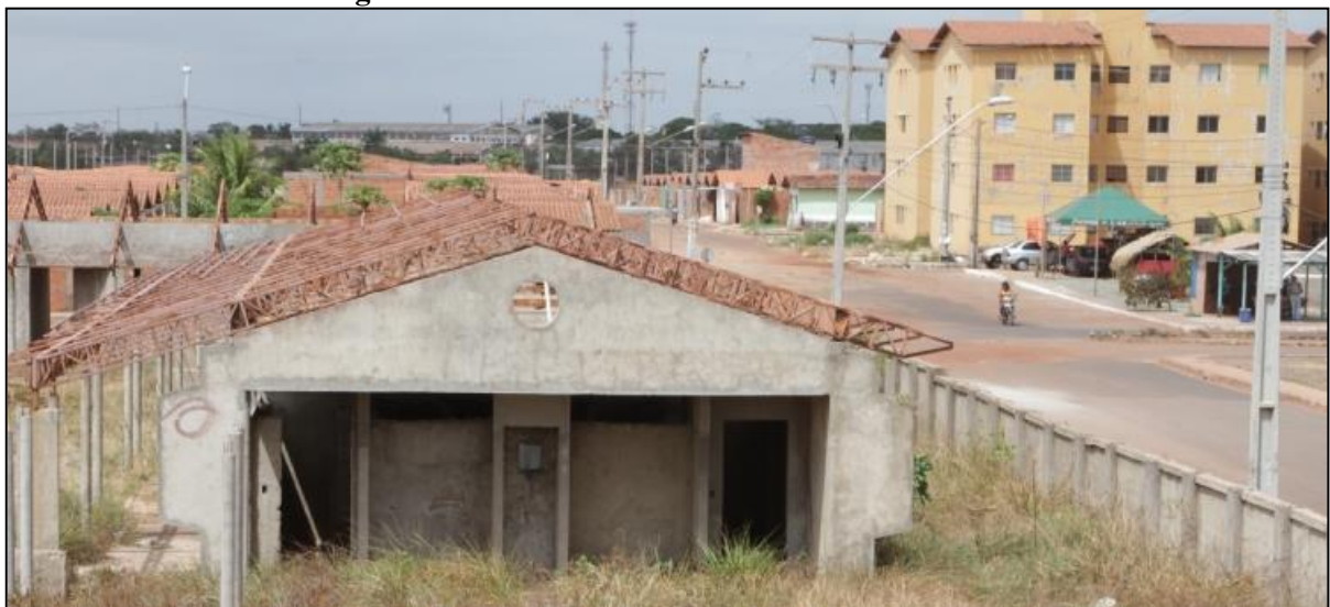
Figura 23 - Escola Inacabada no Residencial Ribeira.
