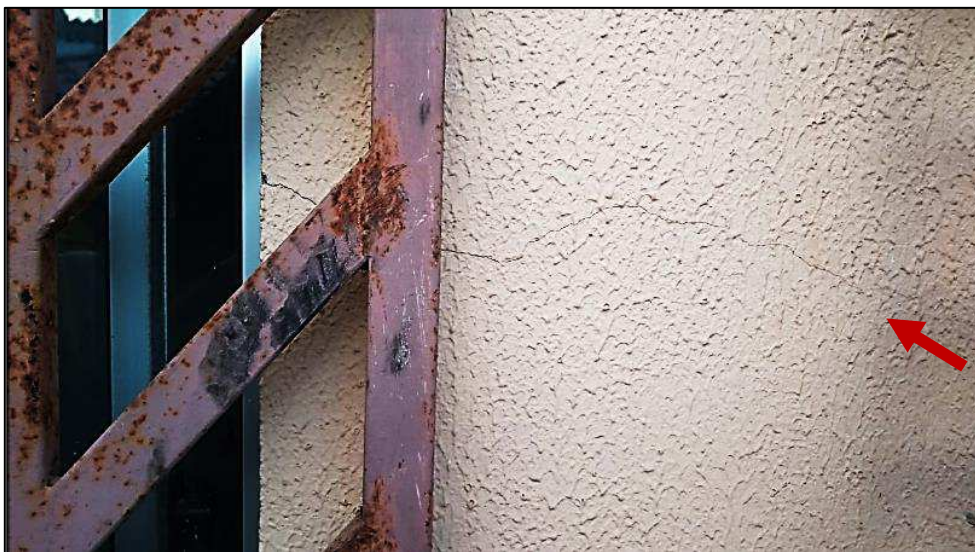
Figura 75: Fissuras entre escápula de rede e esquadria na parede interna do quarto 02.
