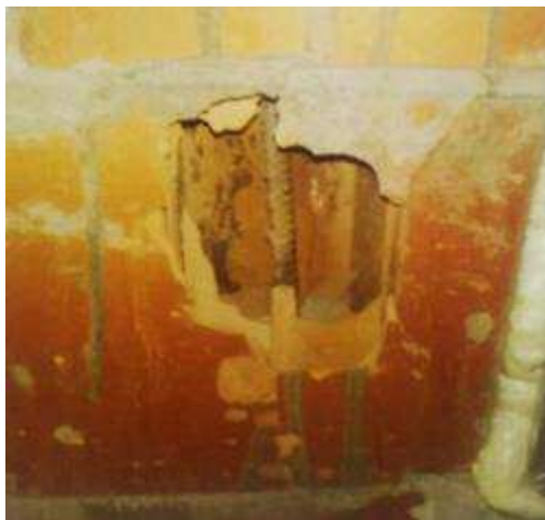
Figura 54: Vazio mostrando as deficiências de concretagem da coluna de graute, deixando a armadura descoberta ou sem proteção.
