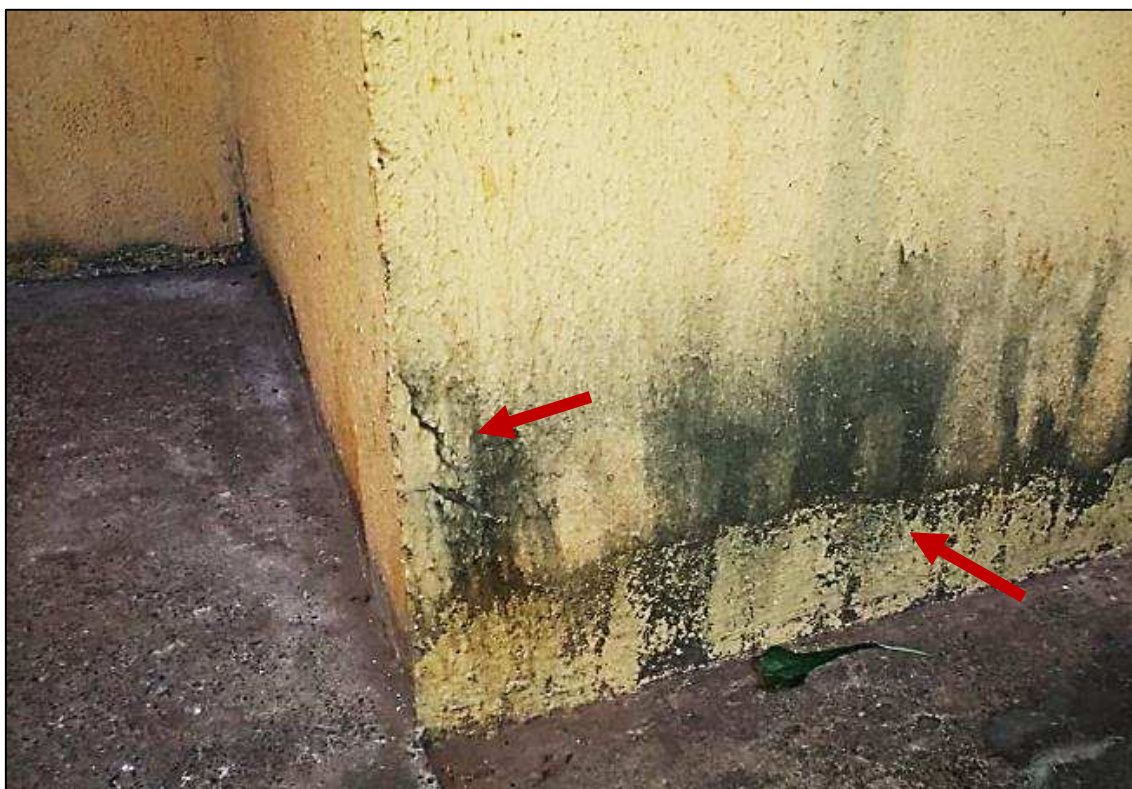
Figura 82: Fissura Horizontal e inclinada em parede externa ao apartamento.
