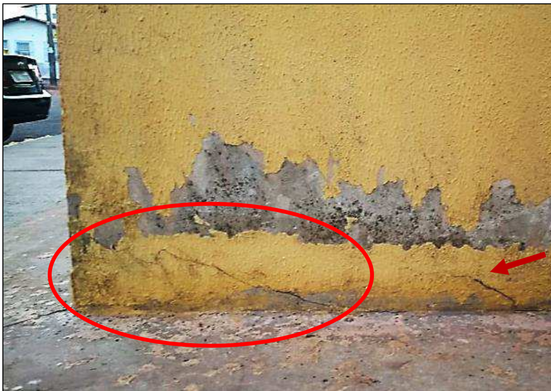
Figura 83: Trincas por recalque diferencial de fundação.
