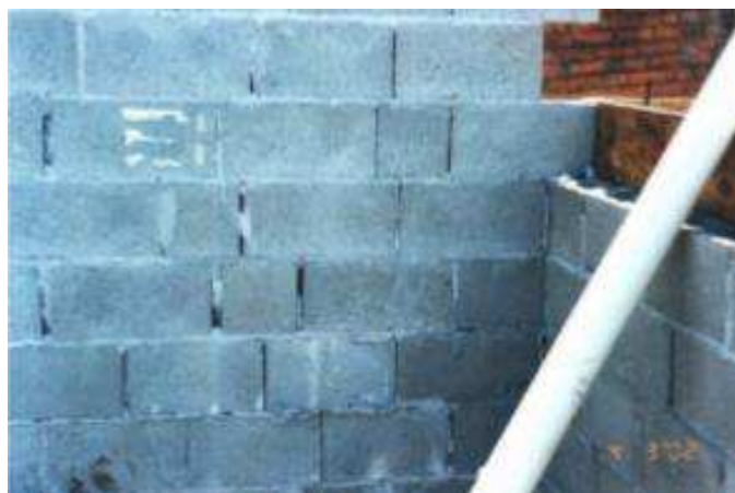
Figura 51: Preenchimento de juntas de forma inadequada.
