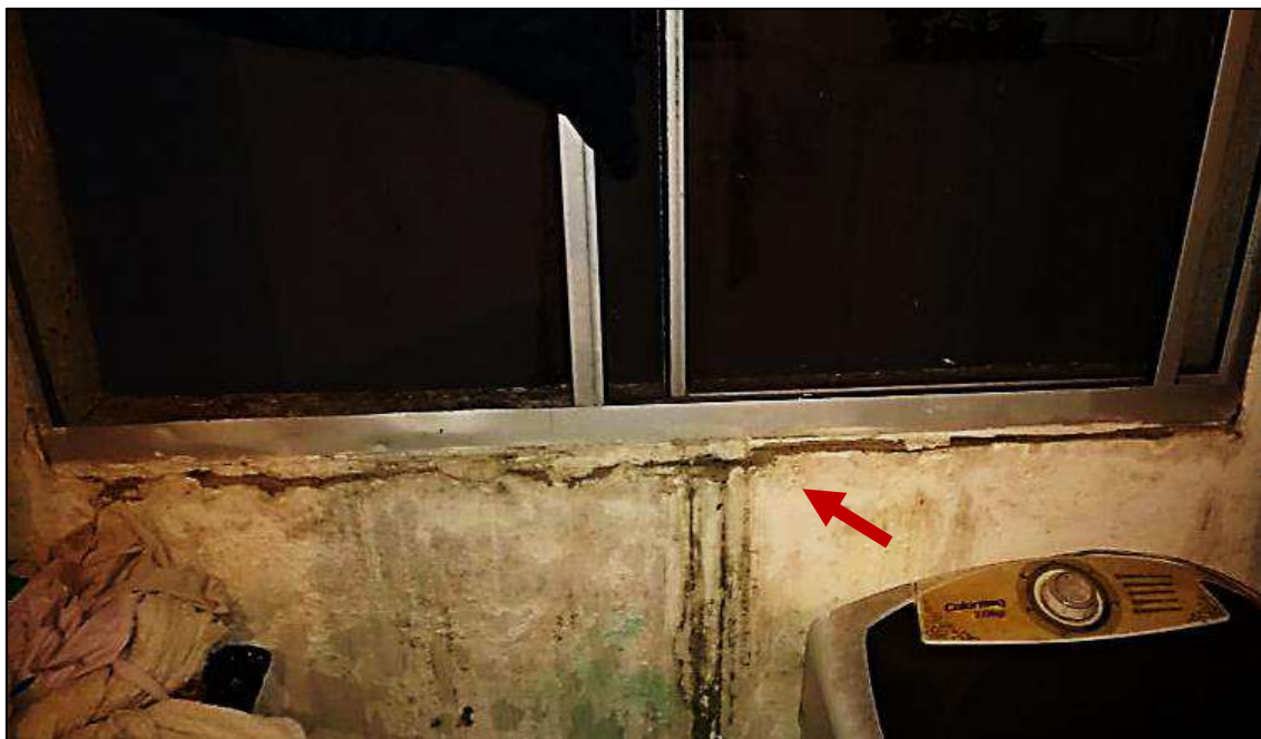
Figura 80: Fissura horizontal sob a esquadria da cozinha.
