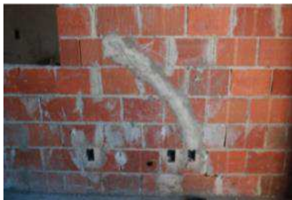
Figura 53: Exemplo de rasgos em alvenaria de bloco cerâmico.
