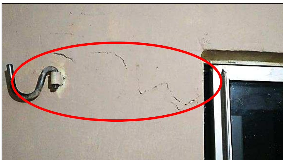
Figura 74: Fissuras entre escápula de rede e esquadria na parede interna do quarto 02.
