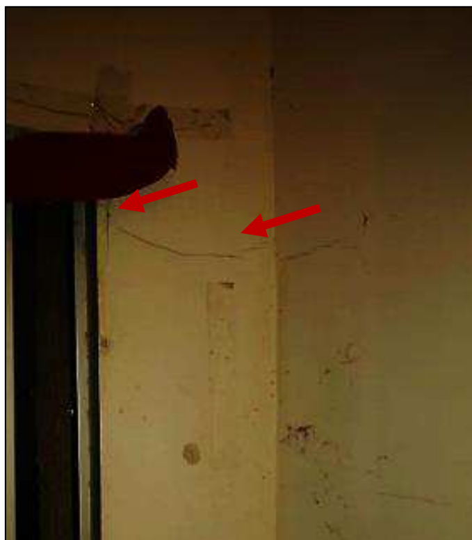
Figura 81: Fissura em canto superior de esquadria.
