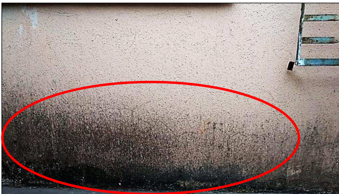
Figura 73: Fissuras e bolor na parede externa dos fundos.
