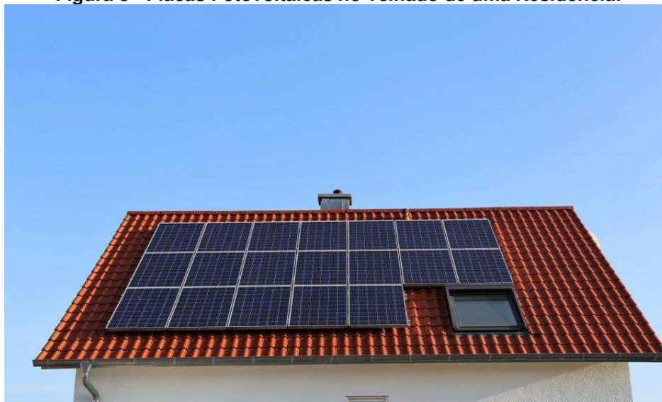
Figura 8 - Placas Fotovoltaicas no Telhado de uma Residência.
