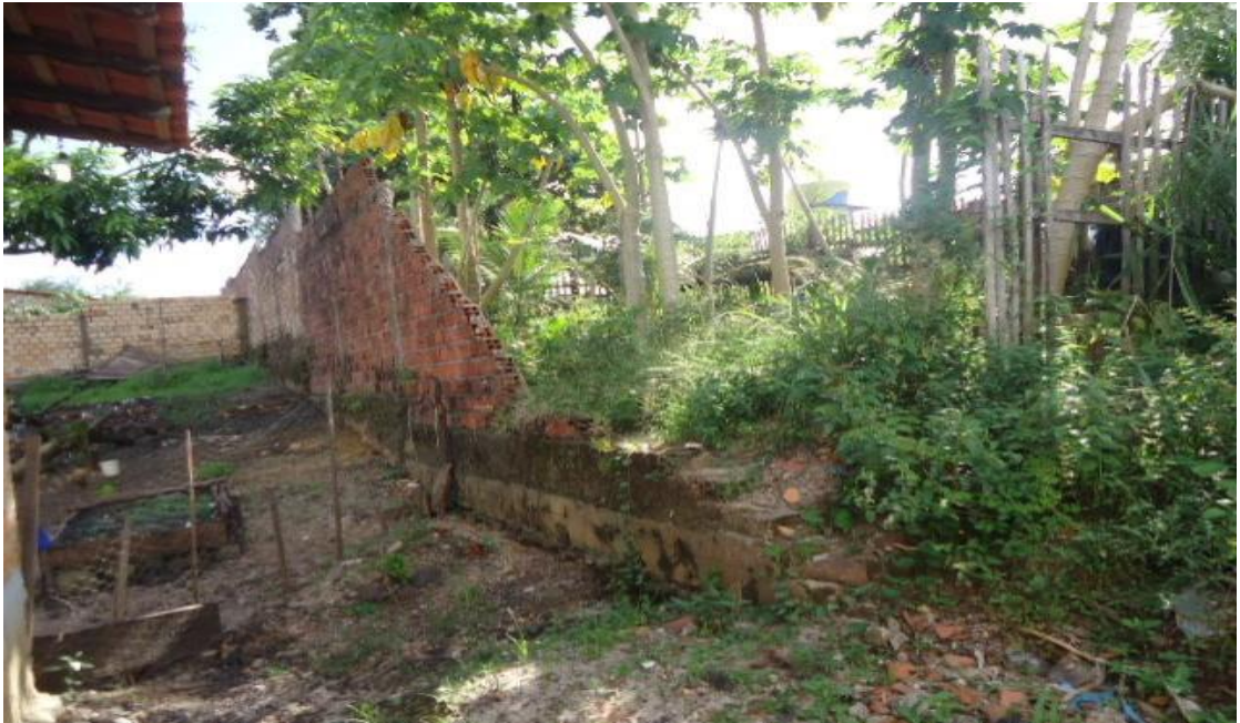
Figura 13 - Muro ao lado derrubado da antiga Delegacia de Governador Nunes Freire
